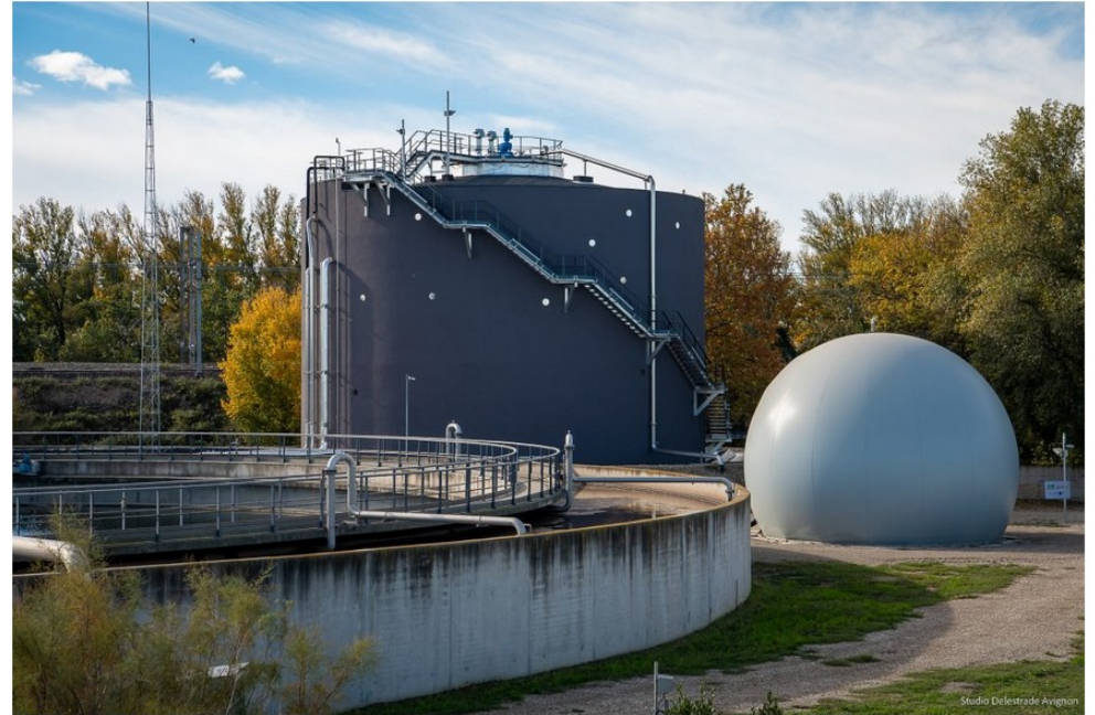
Unité de méthanisation sur la station d'épuration de la Courtine – Avignon
