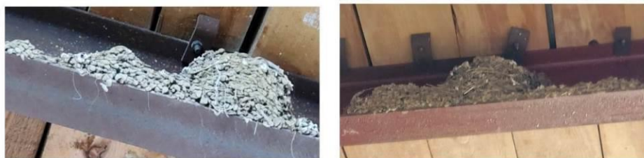
Figure 14 Nids construits avec des matériaux différents (ciment en gris – argile en brun)
