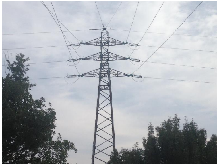
Illustration 5 : Exemple de pylône RTE de raccordement
