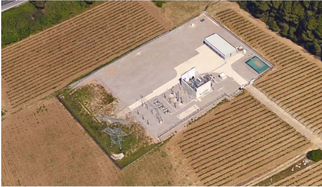
Illustration 4 : Exemple de poste source 225 000 / 20 000 volts, Pont-Trinquat (34)
