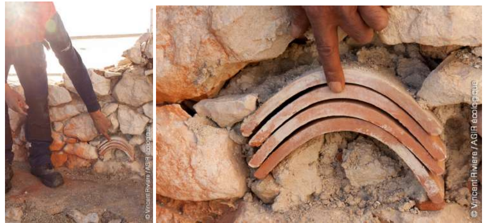
Test de gîte pérenne dans le parapet. L'intervalle entre les tuiles est variable, du fait du galbe également variable des tuiles
