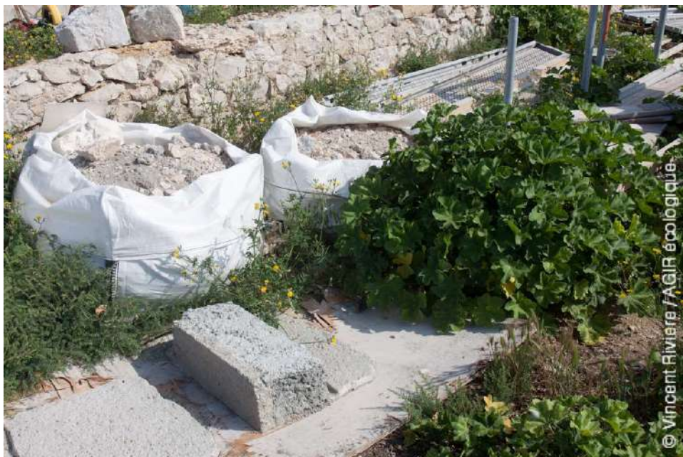
Planche en bois et big bag posés à même le sol
