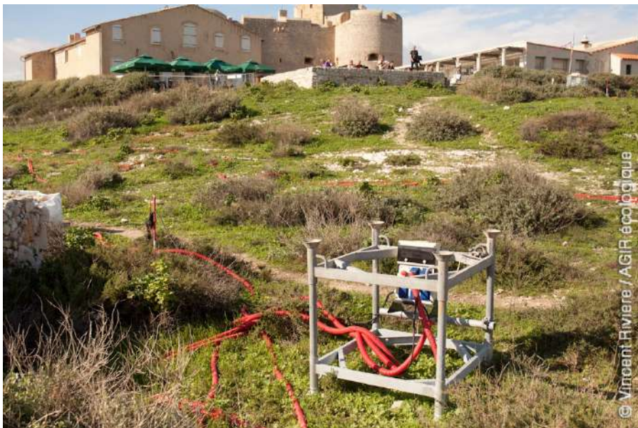
Rack d'échafaudage protégeant le coffret électrique de toute mise en sécurité par inadvertance
