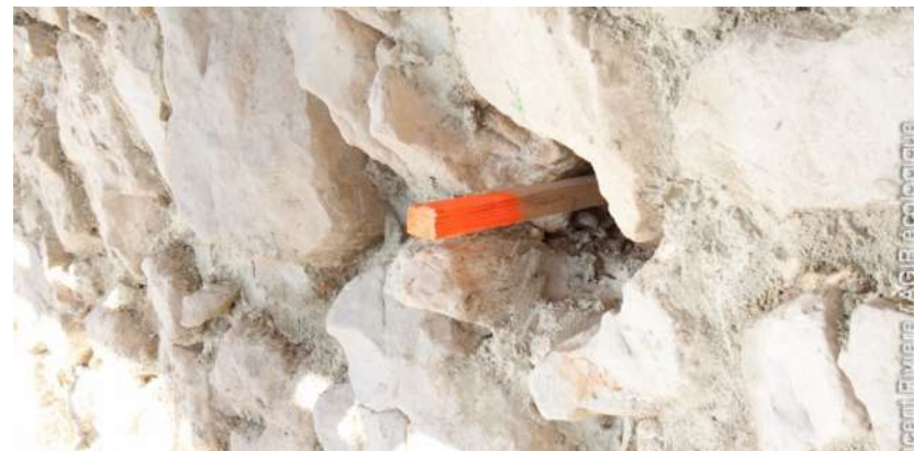
Cavité marquée afin d'éviter leur comblement
