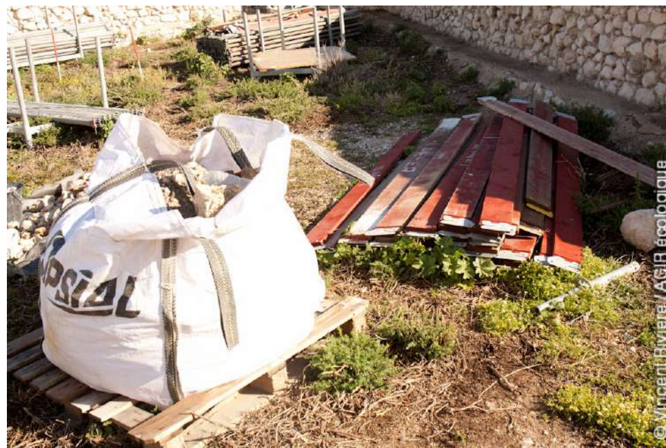
Stockage d'éléments d'échafaudage à même le sol, à proscrire
