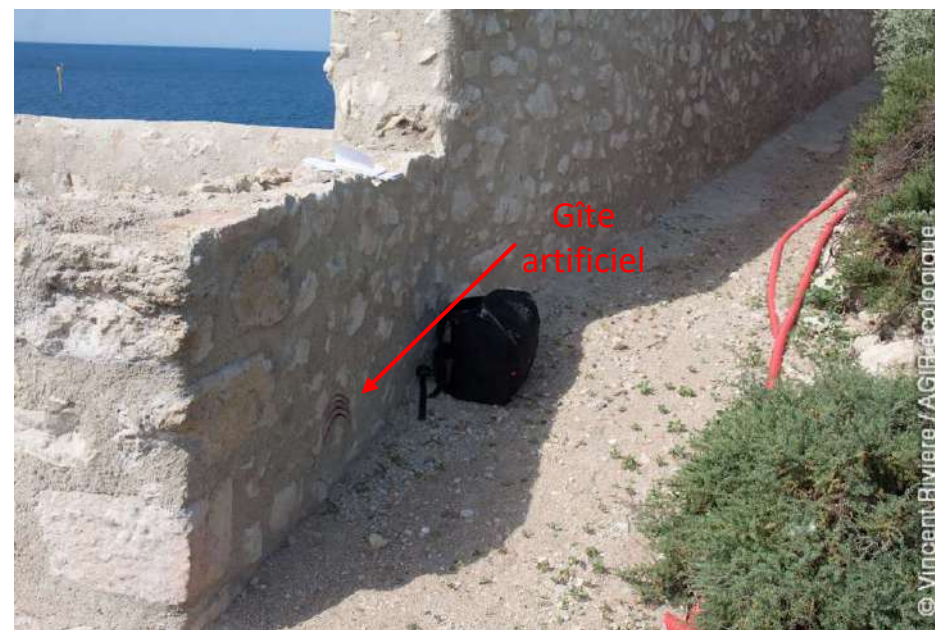
Gîte inséré dans le muret dont la destruction est envisagée
