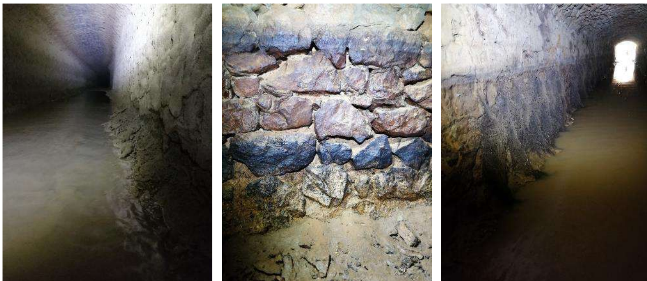
Photos maçonneries dégradées PM 260 (congé), PM 3980 (joints), PM 4030 (racines)
