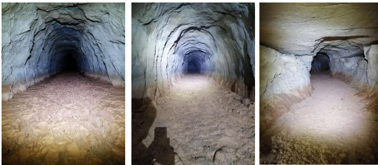
Photos dépôts argileux en radier aux PM 680 – PM 1390 – PM 2100
