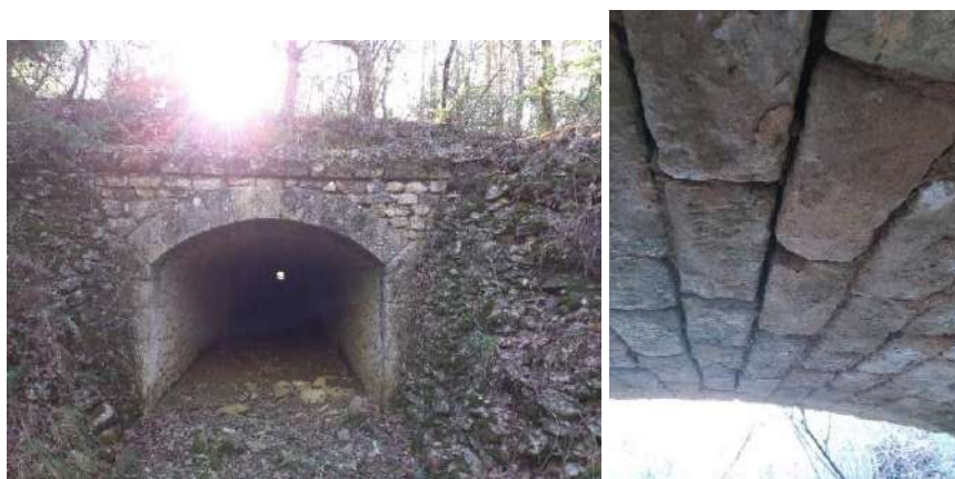
Petit pont en pierre située en limite sud-ouest au sein de l'aire d'étude, gîtes potentiels pour les chiroptères anthropophiles/fissuricoles.
