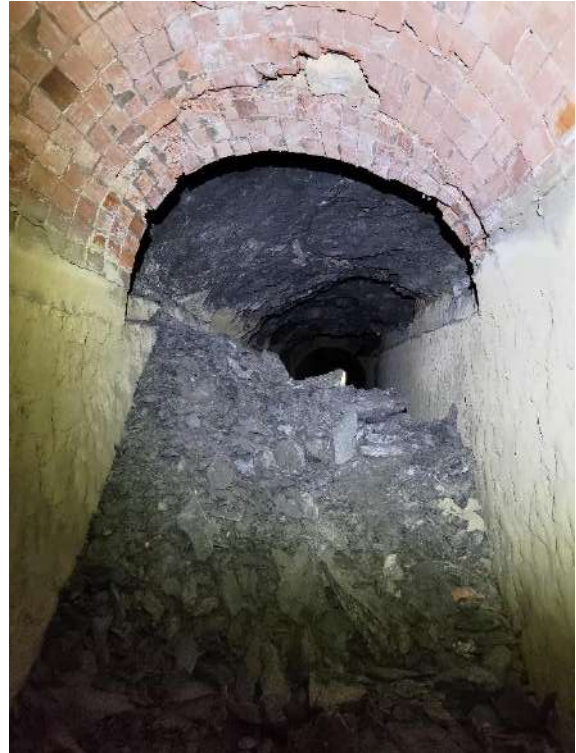
Figure 7 Briques en très mauvais état et éboulement
