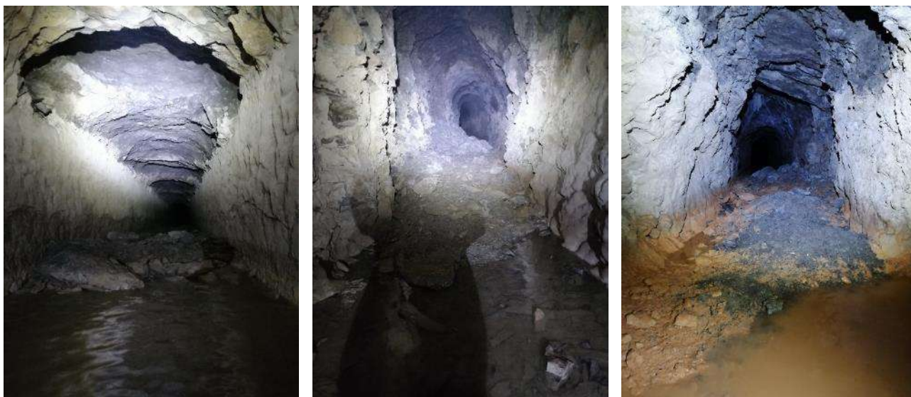
Photos d'éboulements en radier aux PM 100-500-840
