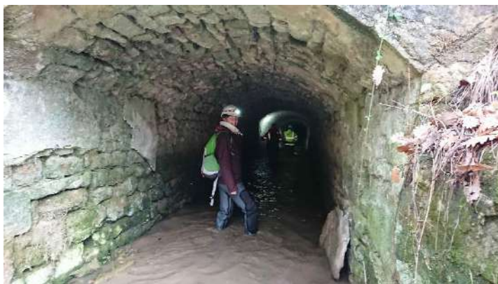
Photo 3 : zones maçonnées en entrée de tunnel
