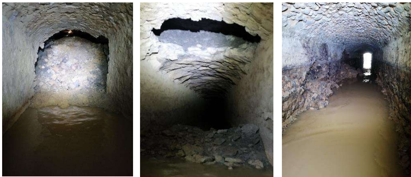
Photos des effondrements de maçonneries aux PM 12 – PM 66 – PM 4070
