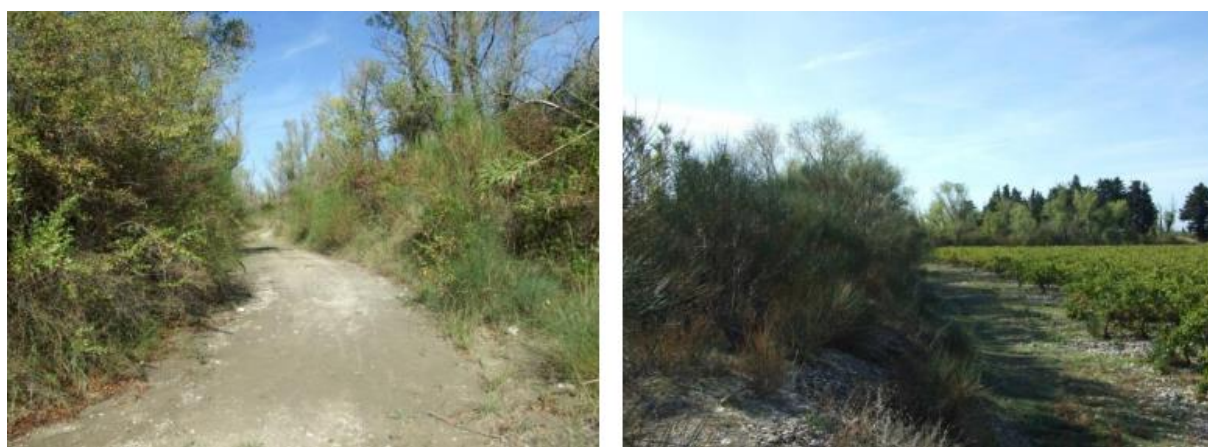
Figure 27 : Merlon le long du chemin d'exploitation amont (à gauche) et le long de la parcelle viticole, en aval de la zone renforcée (à droite)
