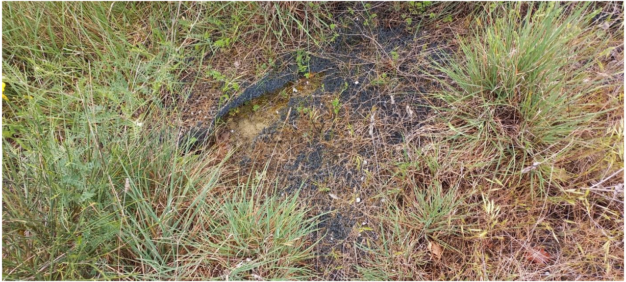
Figure 9 : État des géogrilles de surface
