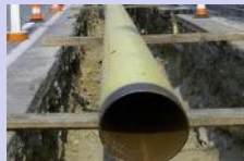
Rupture de canalisation
