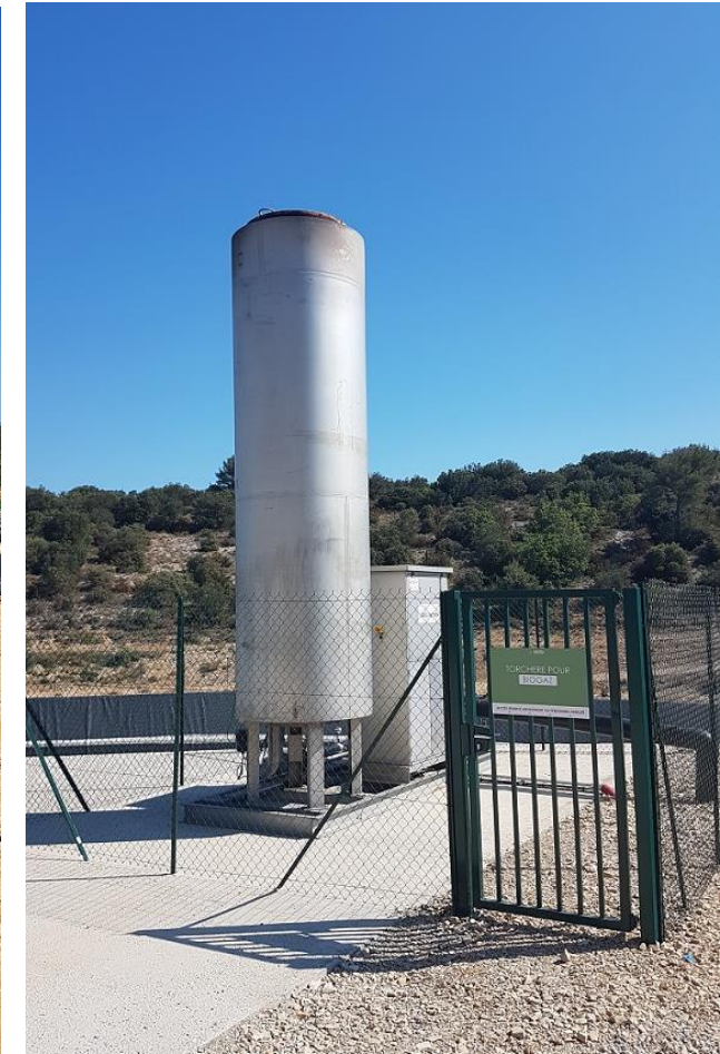
Torchère de brûlage du biogaz
