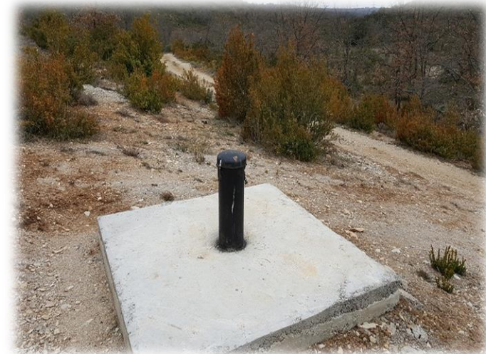
Piézomètre (eaux souterraines)
