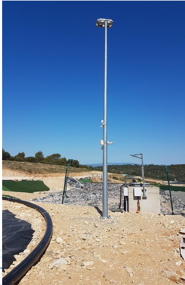
Spot d'éclairage et caméras thermiques
