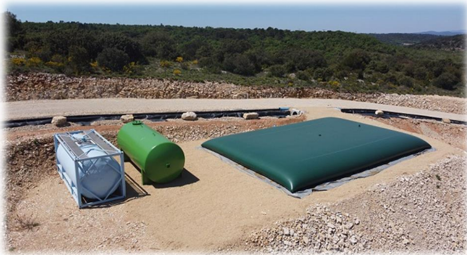
Bâche incendie 200 m 3
