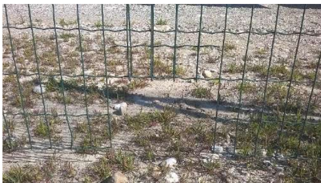
Photo 73. Exemple de trouée dans une clôture de 30 cm par 30 cm
