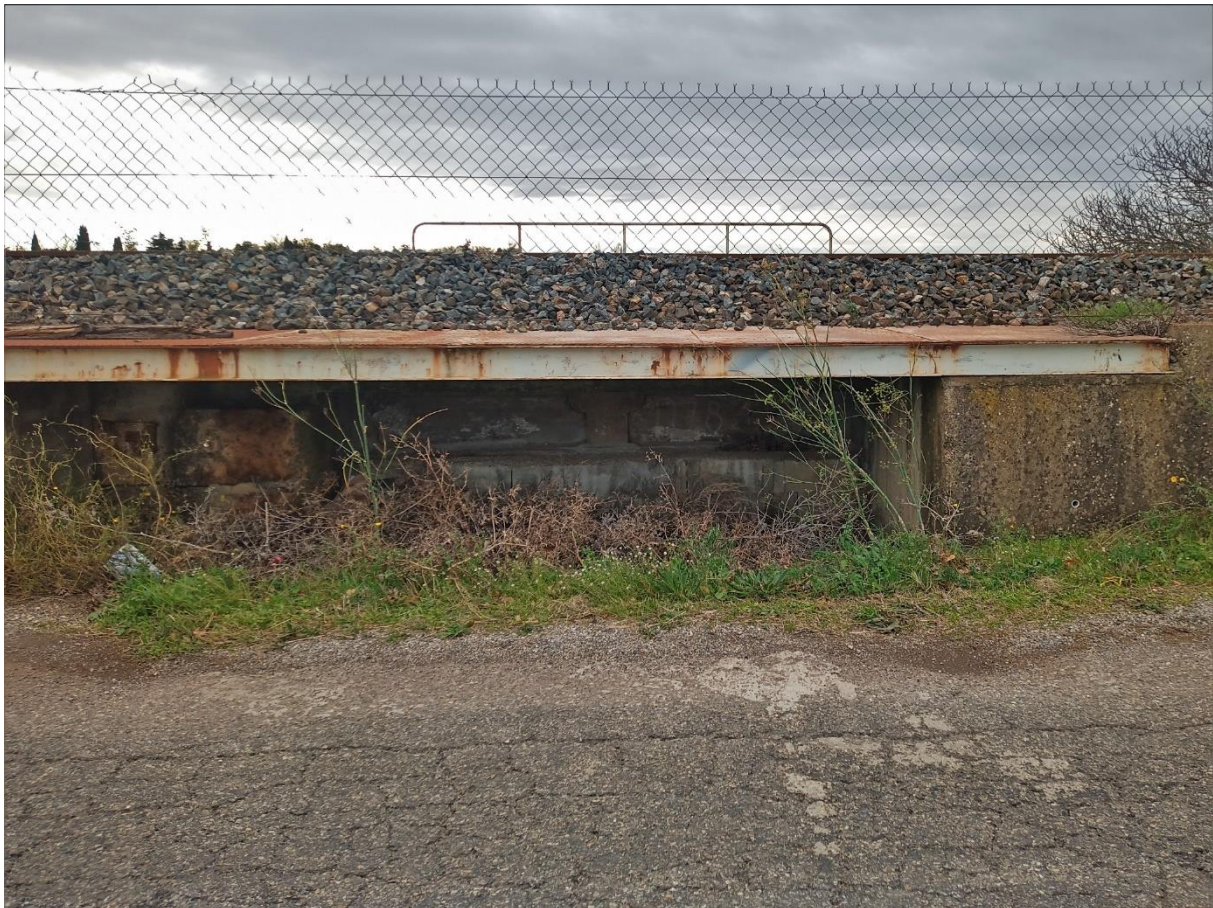
Figure 31 : Ouvrage n°7 muré et non fonctionnel pour la faune
