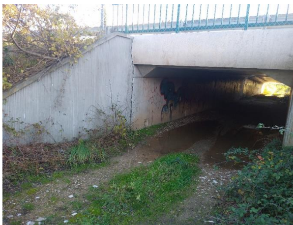
Figure 14 : Ouvrage n°9 parfaitement fonctionnel
