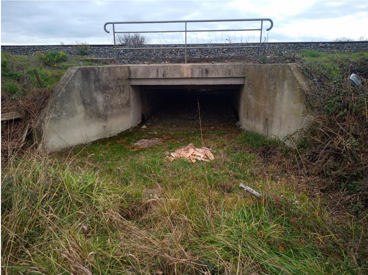
Figure 30 : Ouvrage n°5 favorable à la faune sauvage
