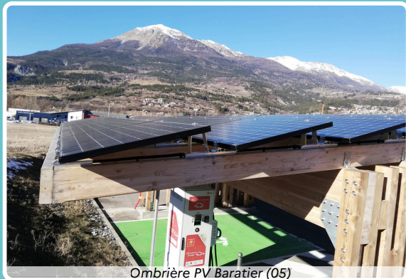
Ombrière PV Baratier (05)
