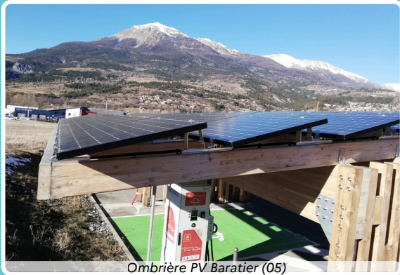
Ombrière PV Baratier (05)
