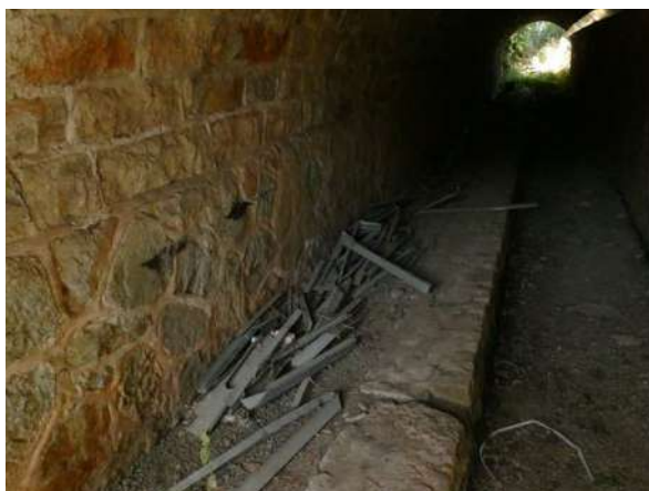
Dépôt sauvage dans l'ouvrage n°28 © Nicolas FUENTO
