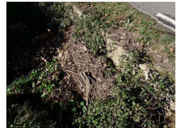
Ouvrage n°9 obstrué par un embâcle © Micaël GENDROT
