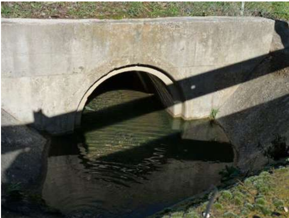
Stagnation d'eau en amont de la buse n°12 © Micaël GENDROT
