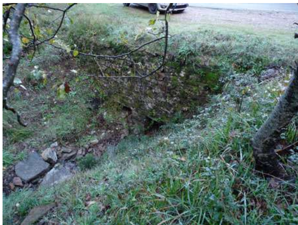
Ouvrage n°22 avec un des deux dalots comblé © Micaël GENDROT
