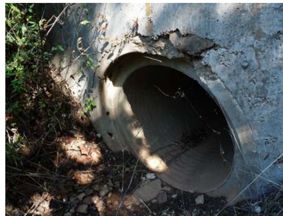
Grille retirée à l'entrée d'un ouvrage pour permettre le passage de la faune © Micaël GENDROT
