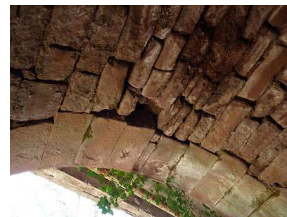
Joints favorables aux chiroptères mais appelant des travaux © Micaël GENDROT
