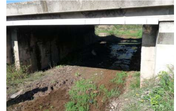
Ouvrage n°61. Sans fossé canalisant l'eau, une nappe de boue à tendance à persister © Micaël GENDROT
