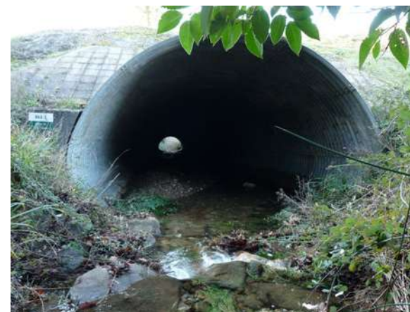
Ouvrage n° 30 avec présence à l'intérieur d'une banquette de sédiment © Micaël GENDROT
