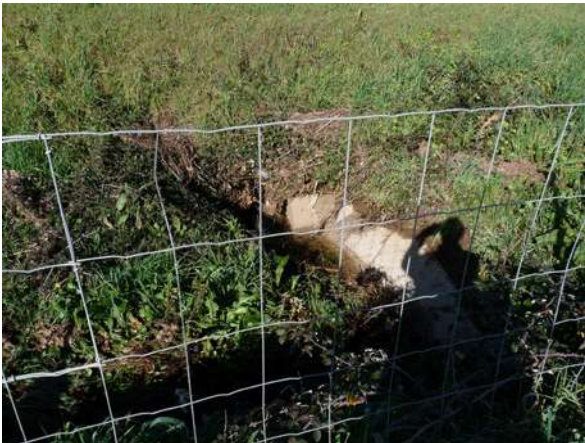
Buse n°11 bouchée © Micaël GENDROT
