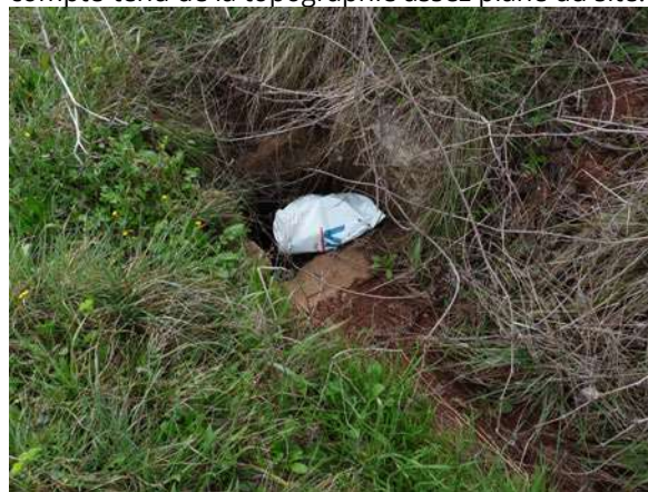
Avaloir et déchets piégés dans l'ouvrage n°8 © Micaël GENDROT
