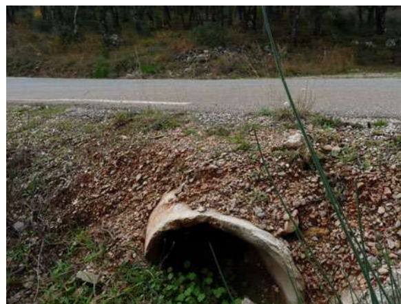
Ouvrage n°3 obstrué à l'amont © Micaël GENDROT
