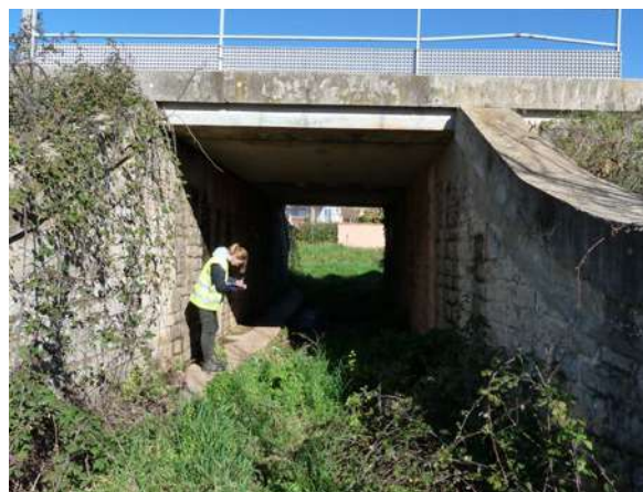
Bassin de rétention présent autour de l'ouvrage n°48. Les berges en béton verticales constituent un risque élevé de noyade pour les animaux qui franchiraient la clôture © Micaël GENDROT
