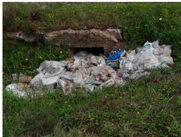
Ouvrage n°6 bouché par un dépôt sauvage de déchets © Micaël GENDROT
