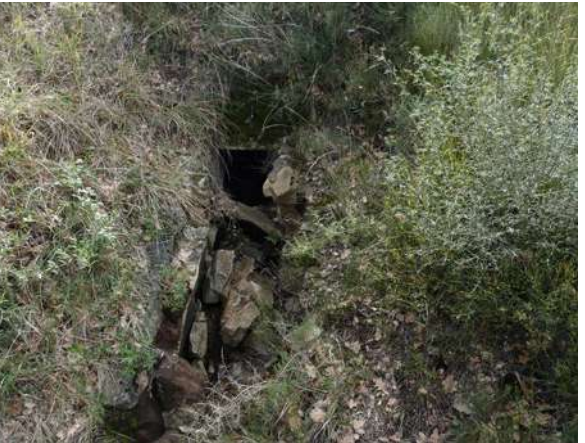
Sortie de l'ouvrage n°9 en partie effondré © Micaël GENDROT
