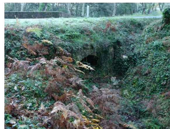
Ouvrage n°17 avec des déchets plastiques © Micaël GENDROT
