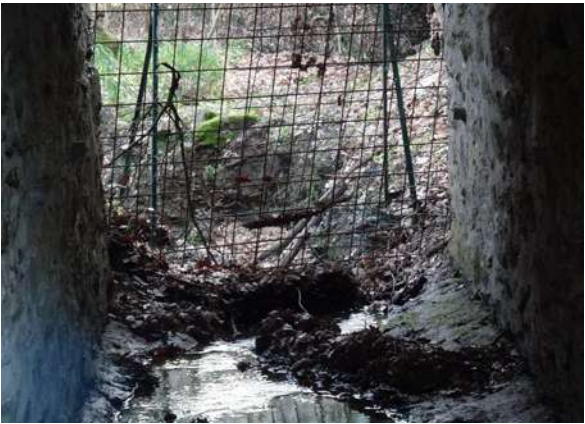
Grille en sortie de l'ouvrage n°12 © Micaël GENDROT
