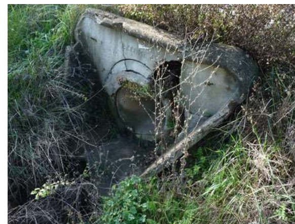
Contour de la tête de l'ouvrage n°6 fissuré à l'aval © Micaël GENDROT
