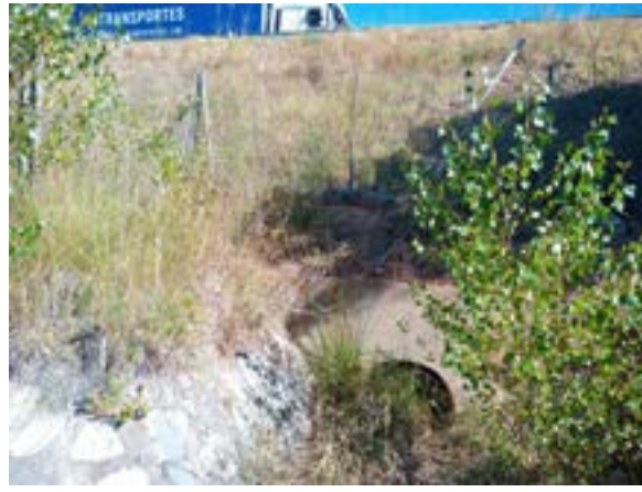
Ouvrage n°9 en partie comblé par les limons © Nicolas FUENTO
