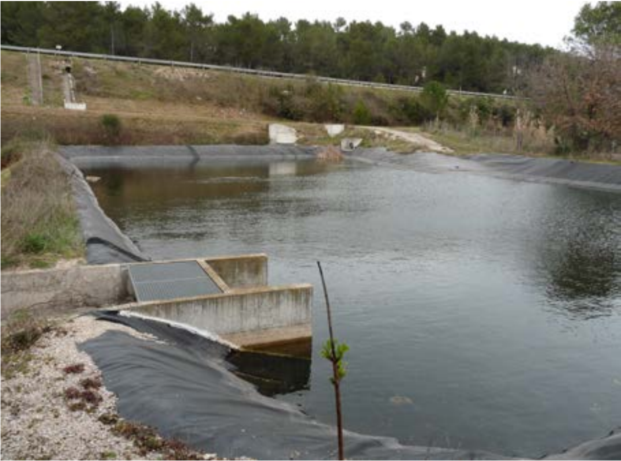
Exemples de bassins de rétention pouvant être dangereux pour la faune : berges glissante © Micaël GENDROT
