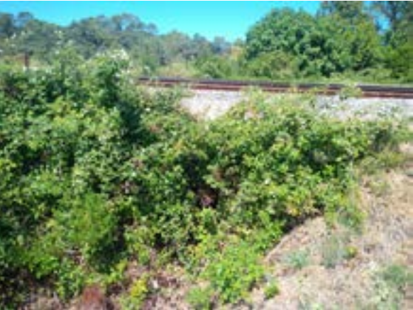
Ouvrage n°32 présentant des entrées ensevelies sous la végétation © Nicolas FUENTO
