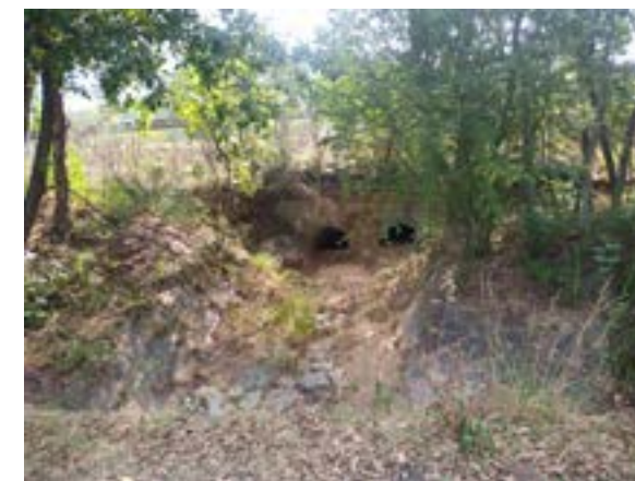
Ouvrage n°30 en partie comblé par les limons © Nicolas FUENTO
