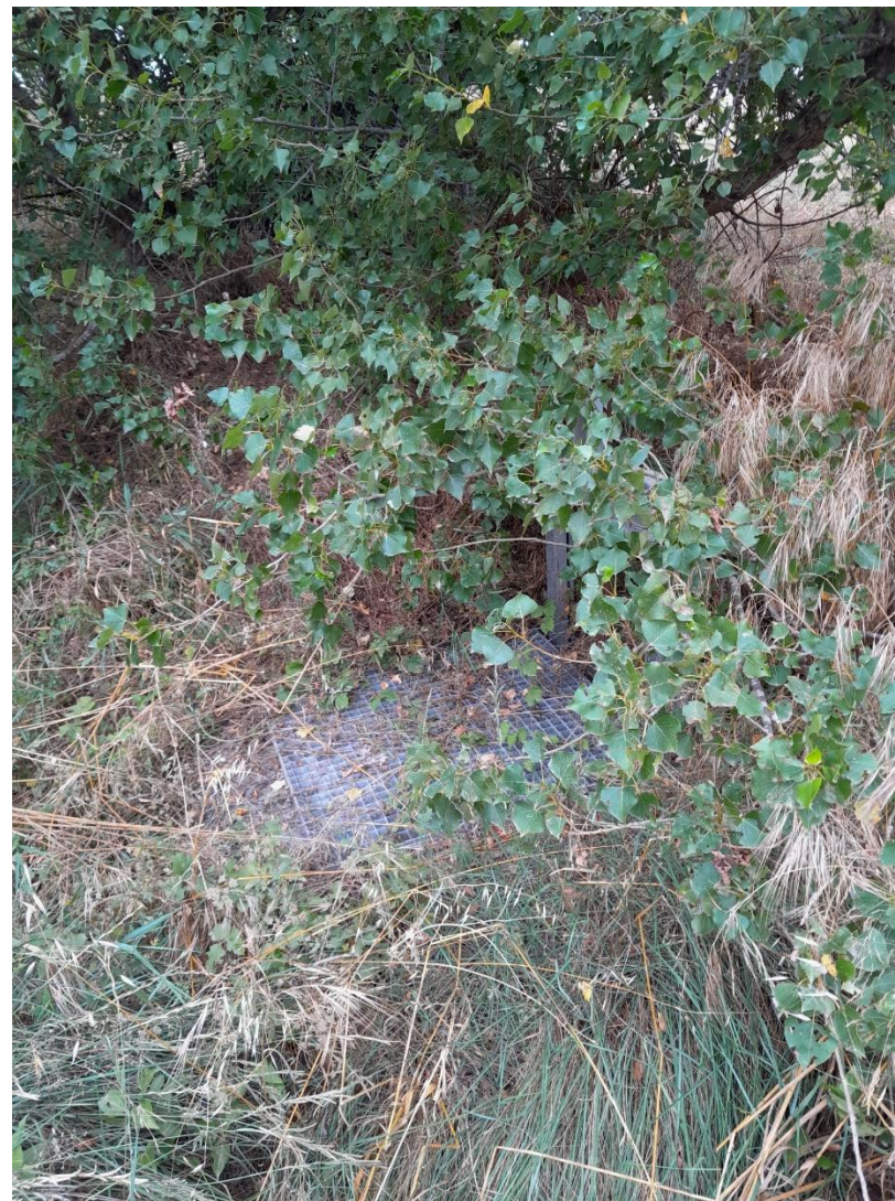
Photographie 6 : Séparateur d'hydrocarbures du bassin de rétention nord-ouest
