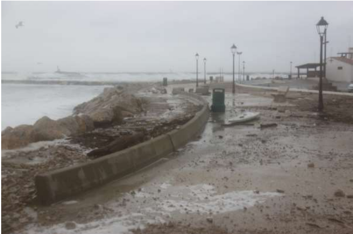
Figure 24. Débris projetés en crête d'ouvrage de protection, partiellement retenus par le mur chasse mer
