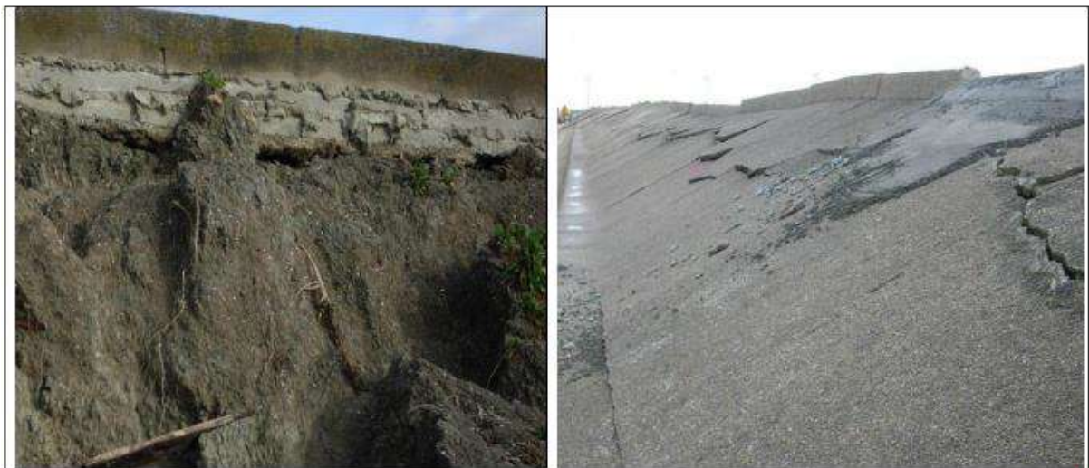
Figure 9. Digue du Bouin (85) : Erosion du remblai par surverse (photo côté ZP) jusqu'à apparition de vides sous les plaques qui s'affaissent (photo côté mer) – Source Irstea
