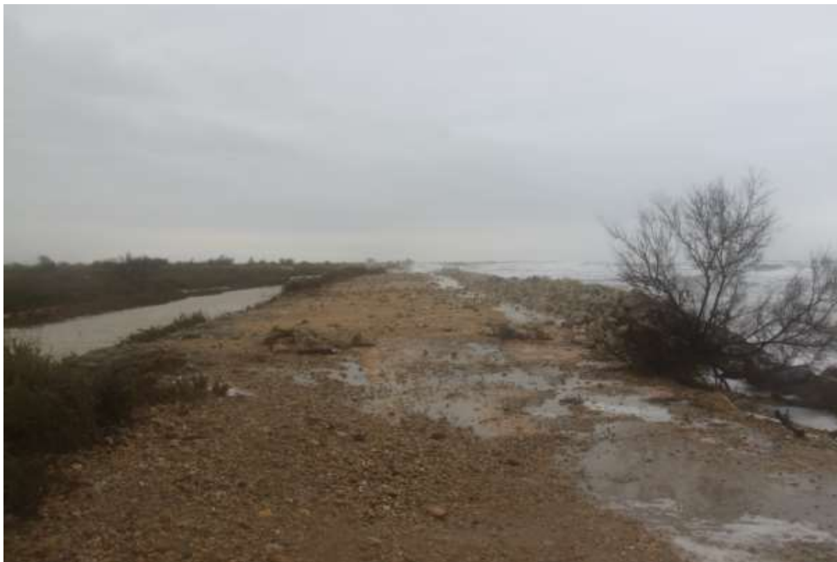
Figure 20. Les galets ont été projeté sur la digue, empêchant l'accès pendant la tempête. Les épis, comme celui de la fourcade, ont également été détériorés.
