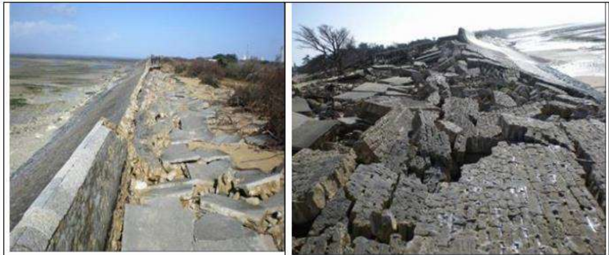
Figure 8. Digue Ouest de Saint Clément des Baleines : Effondrement de la dalle de crête qui peut se poursuivre par un effondrement de la protection en maçonnerie du talus jusqu'à formation d'une brèche – Source DDTM 17
