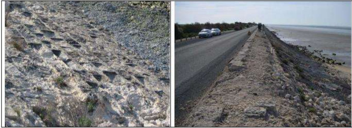
Figure 6. Digue du Génie : Abrasion des pierres côté mer (les joints ciment restent en saillie) et effritement de la crête - Source Irstea
