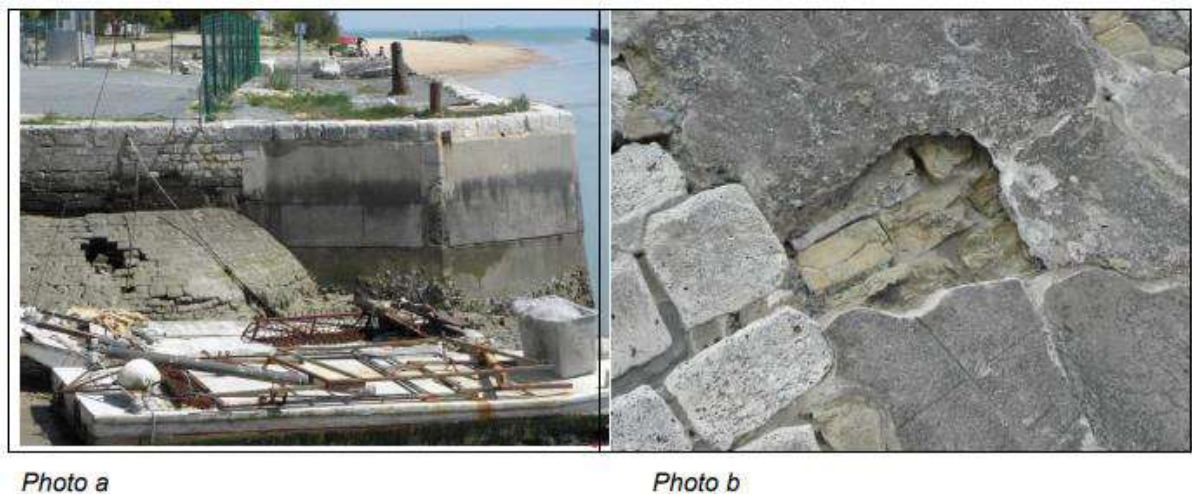
Figure 10. Affaissement plate-forme derrière le quai de Boyardville (photo a) Détail de l'érosion et défaut d'étanchéité du parement de la digue du Nouleau (photo b) – Source Irstea
