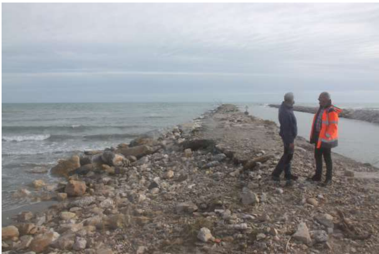
Figure 21. Endommagement de l'enracinement du pertuis de la Fourcade (photo post tempête)
