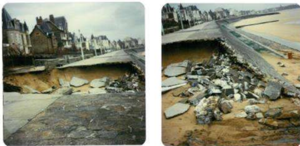
Figure 5. Digue de Paramé à Saint-Malo – Brèche sur le talus amont lors de la tempête de 1979
