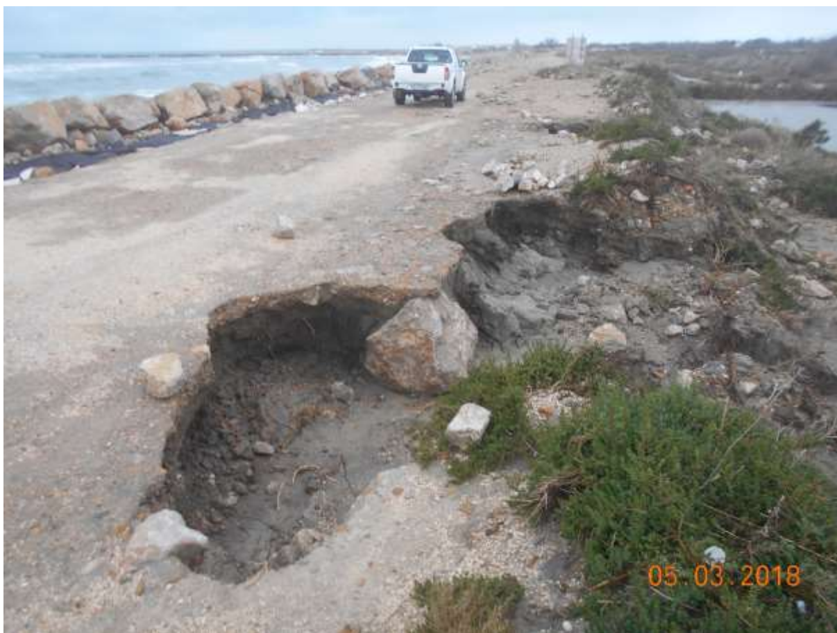
Figure 19. Erosion du talus coté zone protégée
