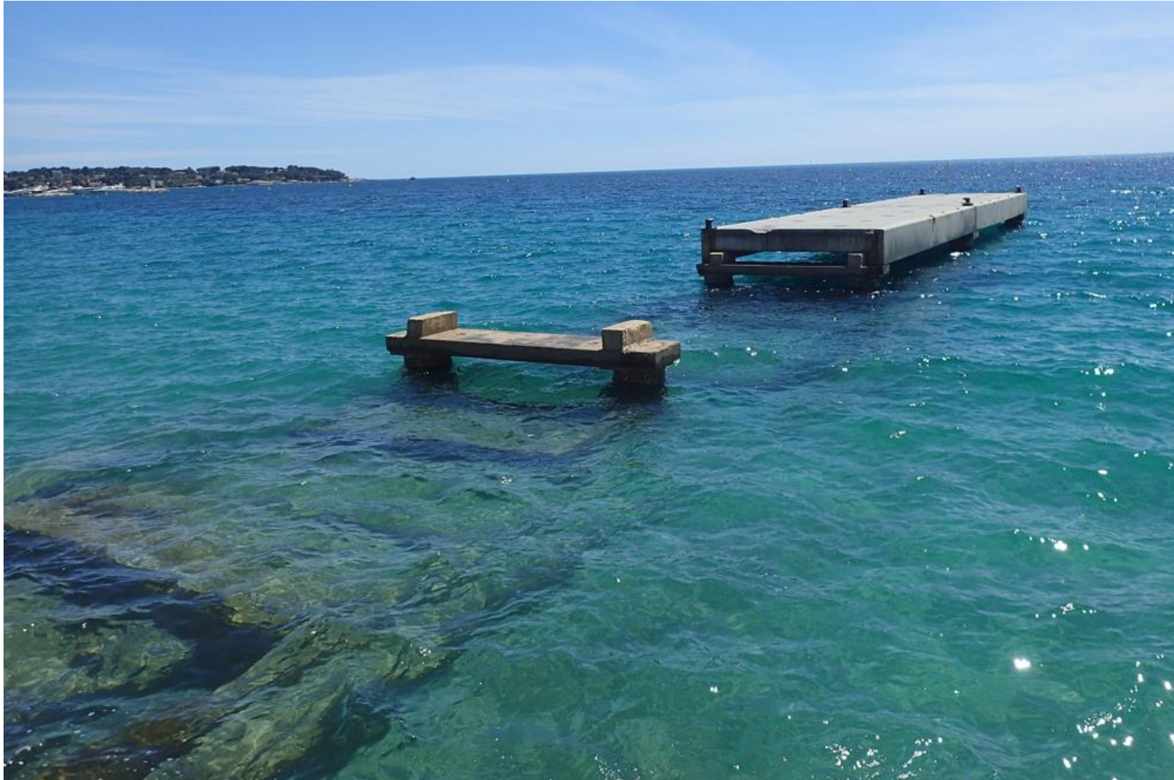
Figure 6. Photo 4 Vue du ponton restant et de la partie effondrée depuis l'autre côté de l'esplanade – ICTP 2018
