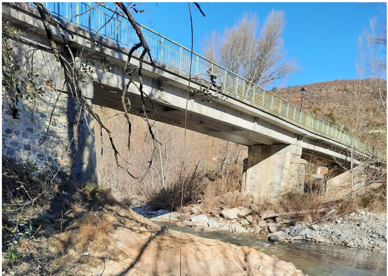
Figure 6 : Amont Pont de SOURRIBES – rive gauche (ERG,2022)
