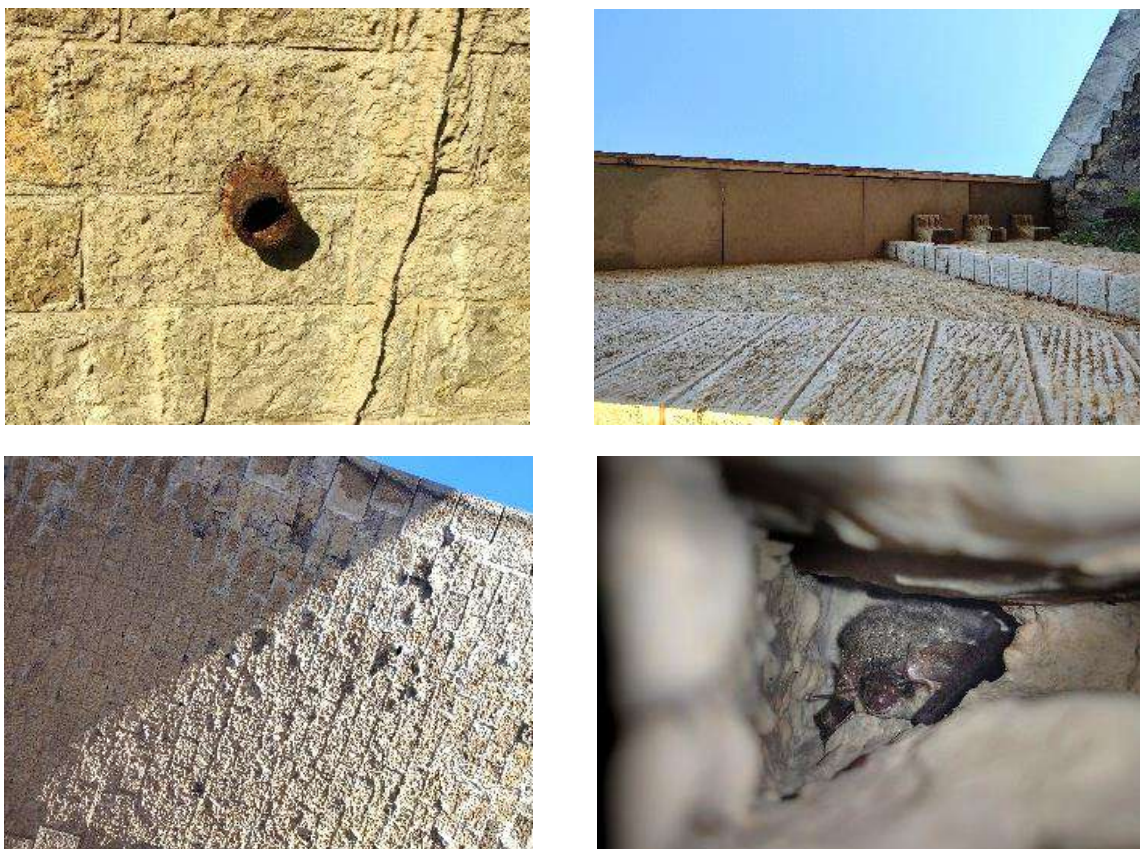
Figure 22. Illustrations des différents micro-habitats favorables aux chiroptères présents sur l'ouvrage d'art et photographie d'un Oreillard gris, observé au sein de l'une des nombreuses micro-fissures (Photos sur site)
