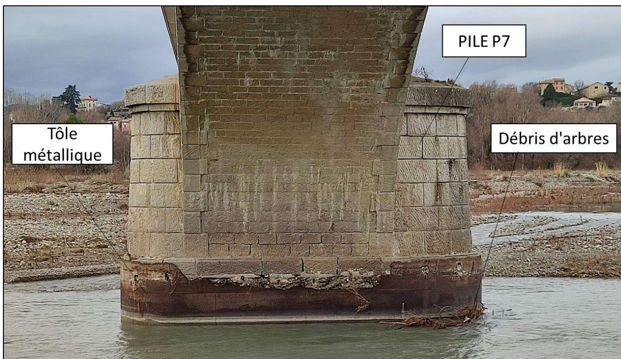
Figure 4 : La tôle métallique très dégradée sur la PILE P7 (ERG, 20/12/2022)
