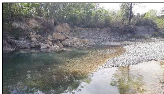
Affouillement au niveau d'un effondrement de blocs
