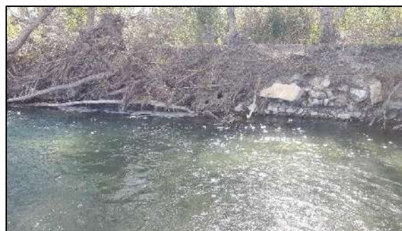
Pied de berge affouillé et embâcle ligneux au niveau d'un front d'érosion
