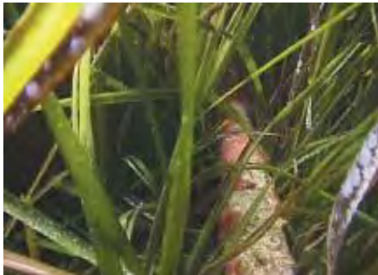
Figure 67 : Câble électrique SACOI entre la Corse et la Sardaigne, simplement posé sur l'herbier près de Cala di Sciumara (Corse). 35 ans après sa mise en place (en 1967), il n'y a pas d'impact négatif sur l'herbier. D'après Pergent et al. (2002b)
