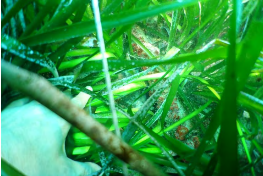
Figure 73 : Câble télécom au sein d'un herbier entre les faisceaux de posidonie (Marseille, 2020)
