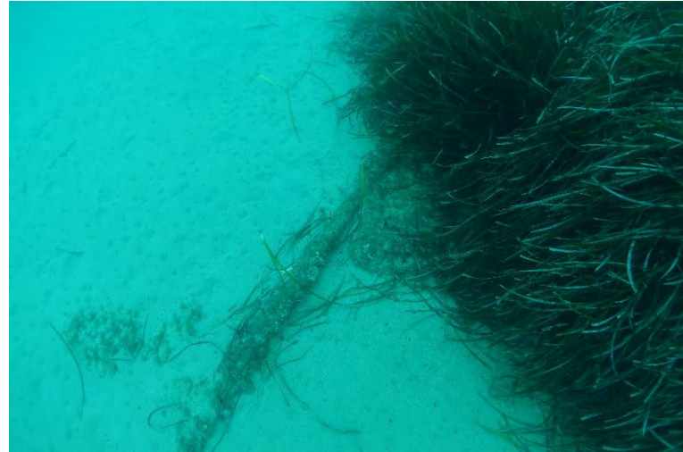
Figure 76 : Câble télécom en sortie d'herbier en limite supérieure (Marseille, 2020)
