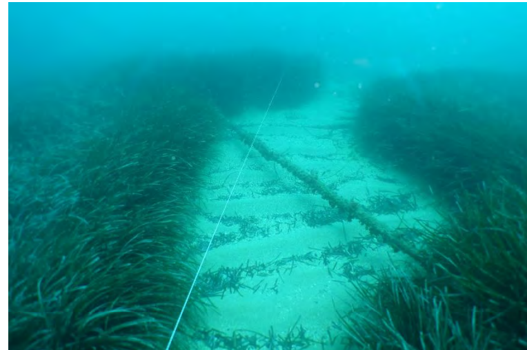
Figure 78 : Câble télécom en suspension au passage d'une zone d'intermatte (Marseille, 2020)
