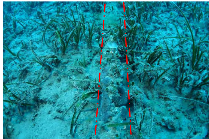
Figure 79 : Câble de transport d'énergie SACOI2 en limite inférieure de l'herbier entièrement colonisé (Bastia - plage de l'Arinella, 2020)
