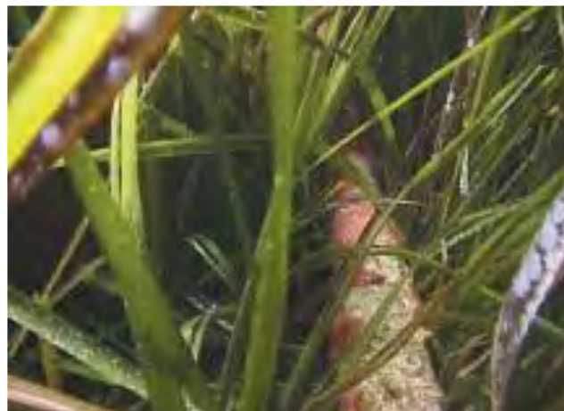
Figure 75 : Câble électrique SACOI entre la Corse et la Sardaigne, simplement posé sur l'herbier près de Cala di Sciumara (Corse). 35 ans après sa mise en place (en 1967), il n'y a pas d'impact négatif sur l'herbier. D'après Pergent et al. (2002b).
