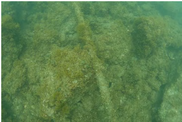
Figure 86 : Câble télécom sur des enrochements (Marseille, 2020)
