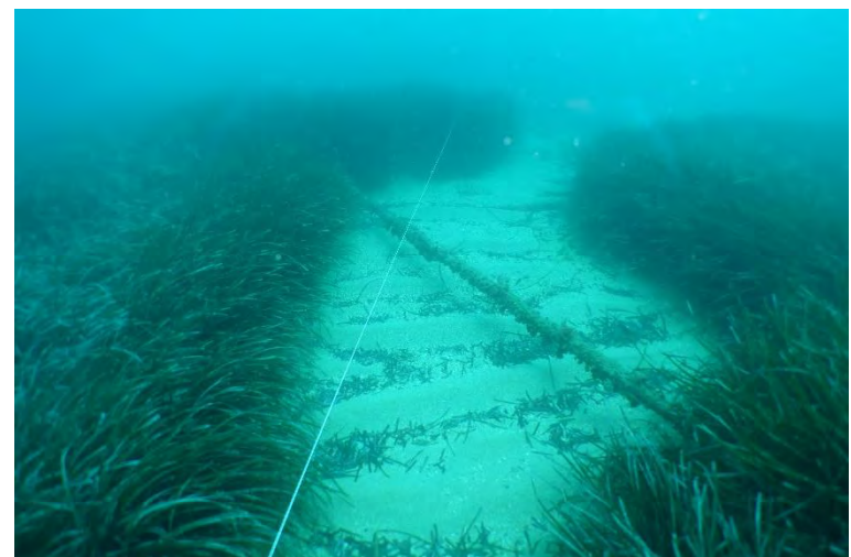
Figure 84 : Câble télécom en suspension au passage d'une zone d'intermatte (Marseille, 2020)
