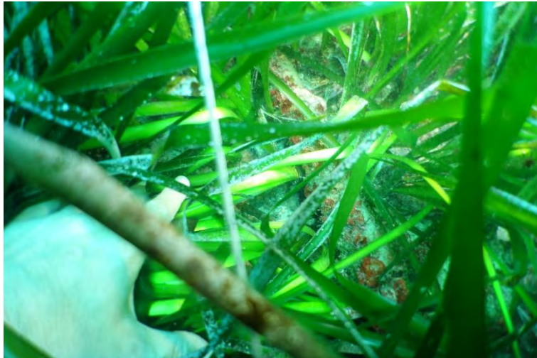
Figure 85 : Câble télécom au sein d'un herbier entre les faisceaux de posidonie (Marseille, 2020)
