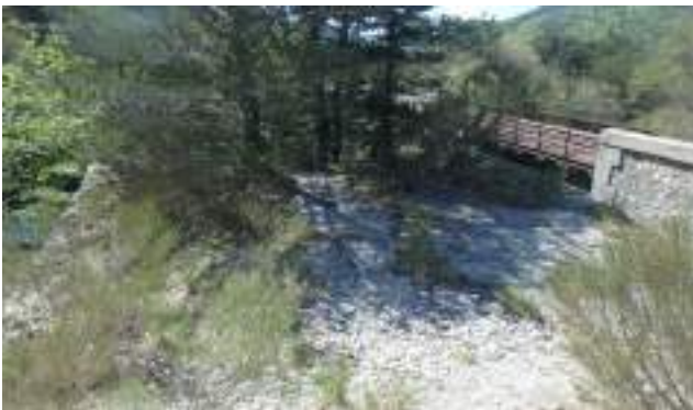
Construction abandonnée colonisée par des Orpins
