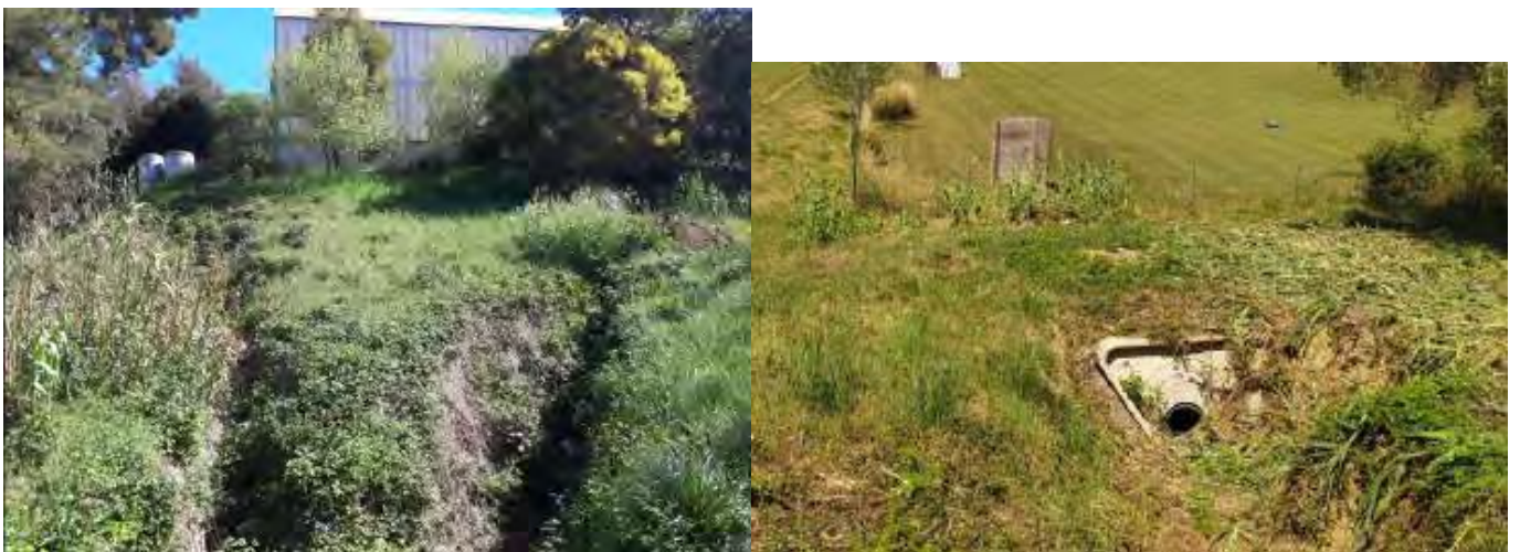
Figure 10 : Canalisations du réseau communal à l'est de la zone projet Padel (vue vers l'est à gauche, vue vers l'ouest à droite), ERG 2018, ICTP 2023,
