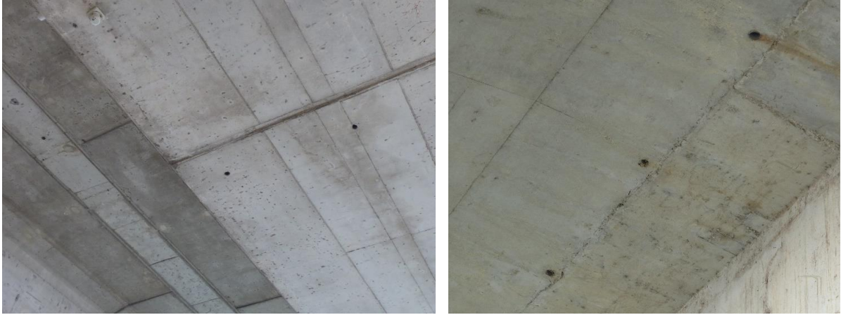
Figure 36 : Détail des drains faiblement favorables au gîte des chiroptères des deux ponts routiers, 08/03/2023, L. PASCHETTO
