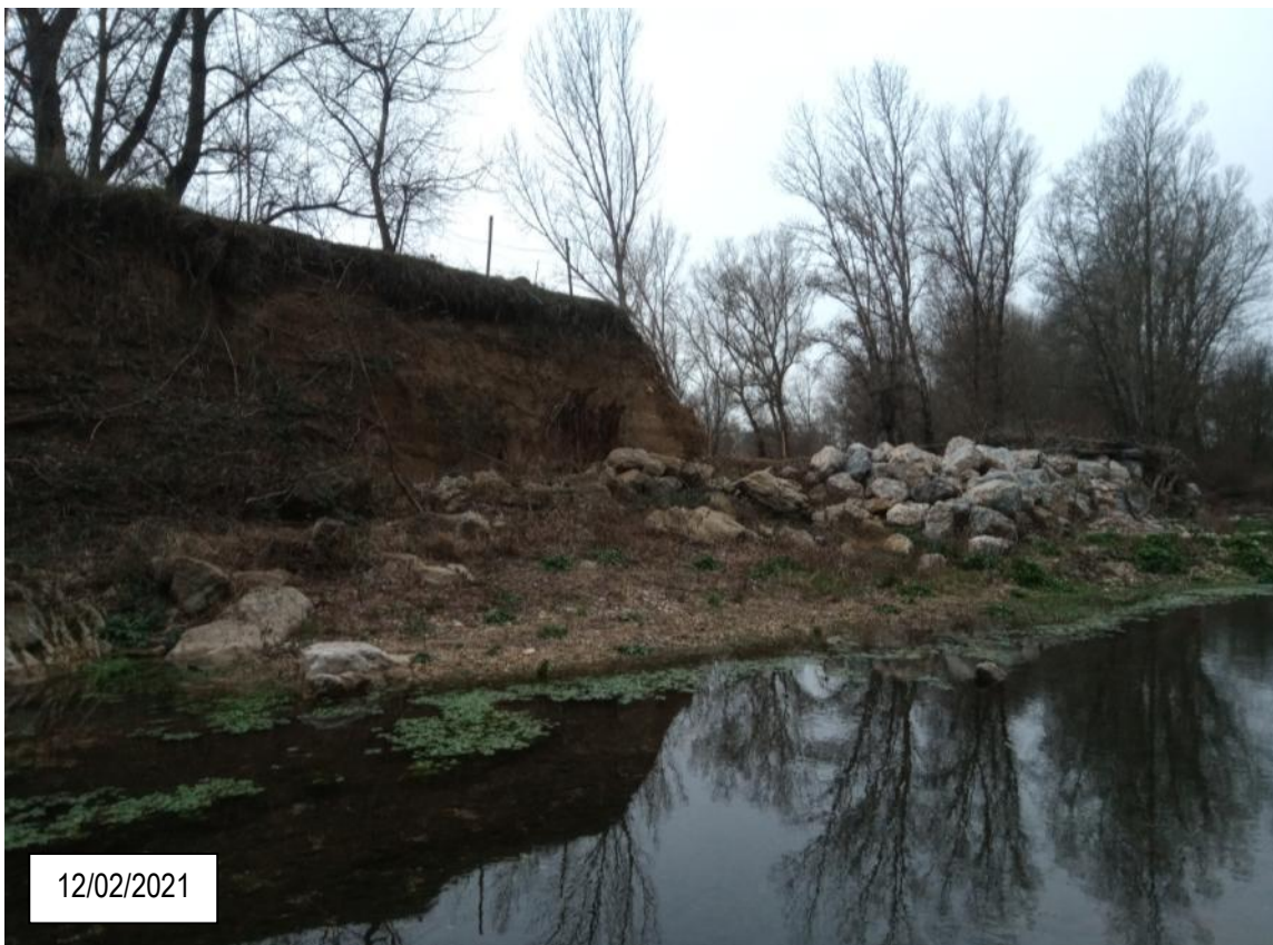
Figure 5 : Protection de berge en rive droite à conforter et prolonger (vue depuis l'aval)
