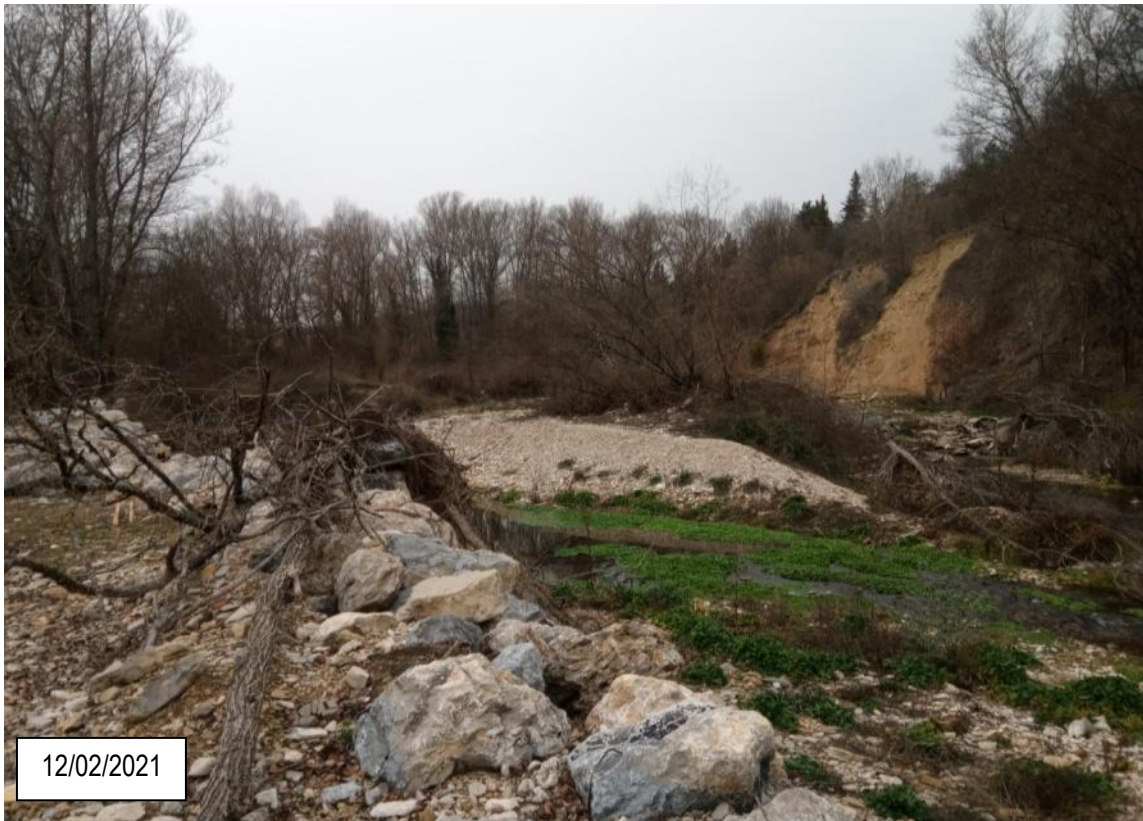
Figure 4 : Protection de berge en rive droite à conforter au premier plan et atterrissement à supprimer au second plan (vue depuis l'aval)
