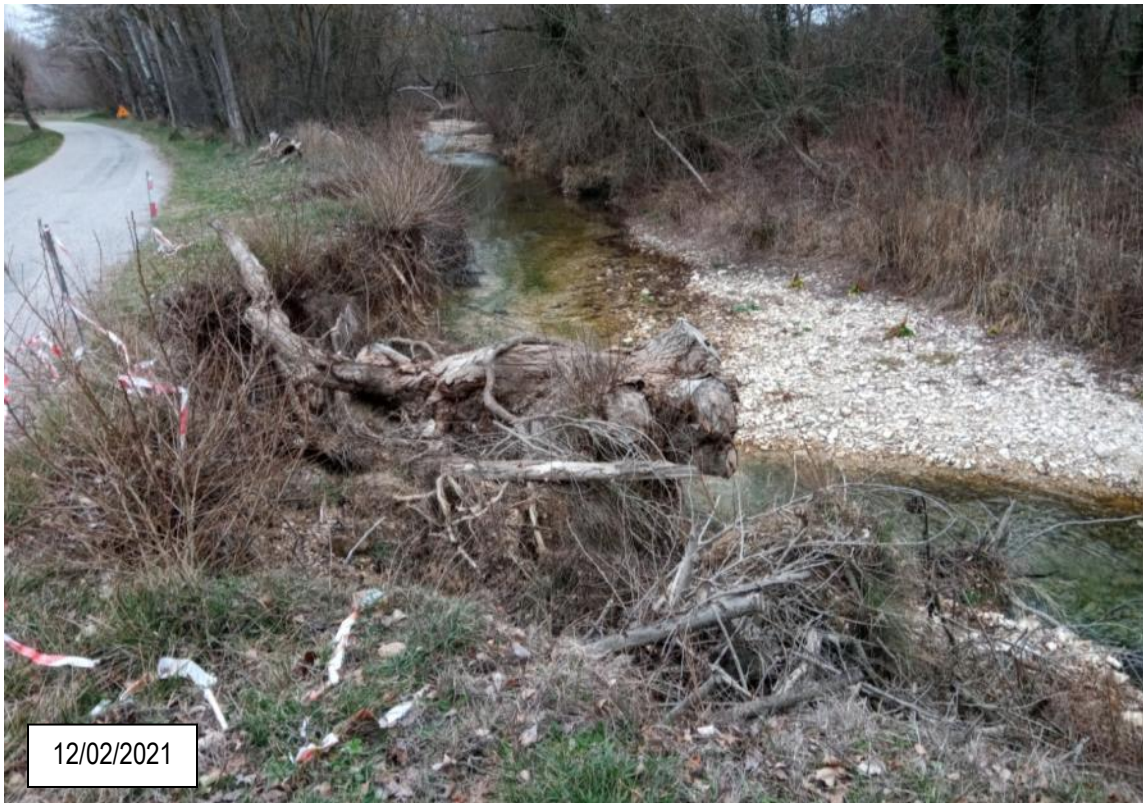
Figure 27 : Berge à conforter en rive droite (vue depuis l'aval)
