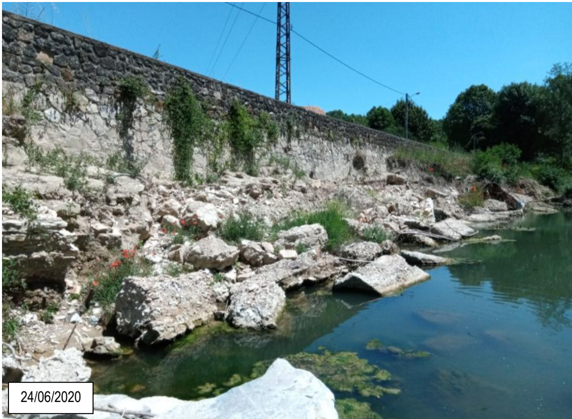
Figure 17 : Berge à conforter en rive gauche (vue depuis l'amont)
