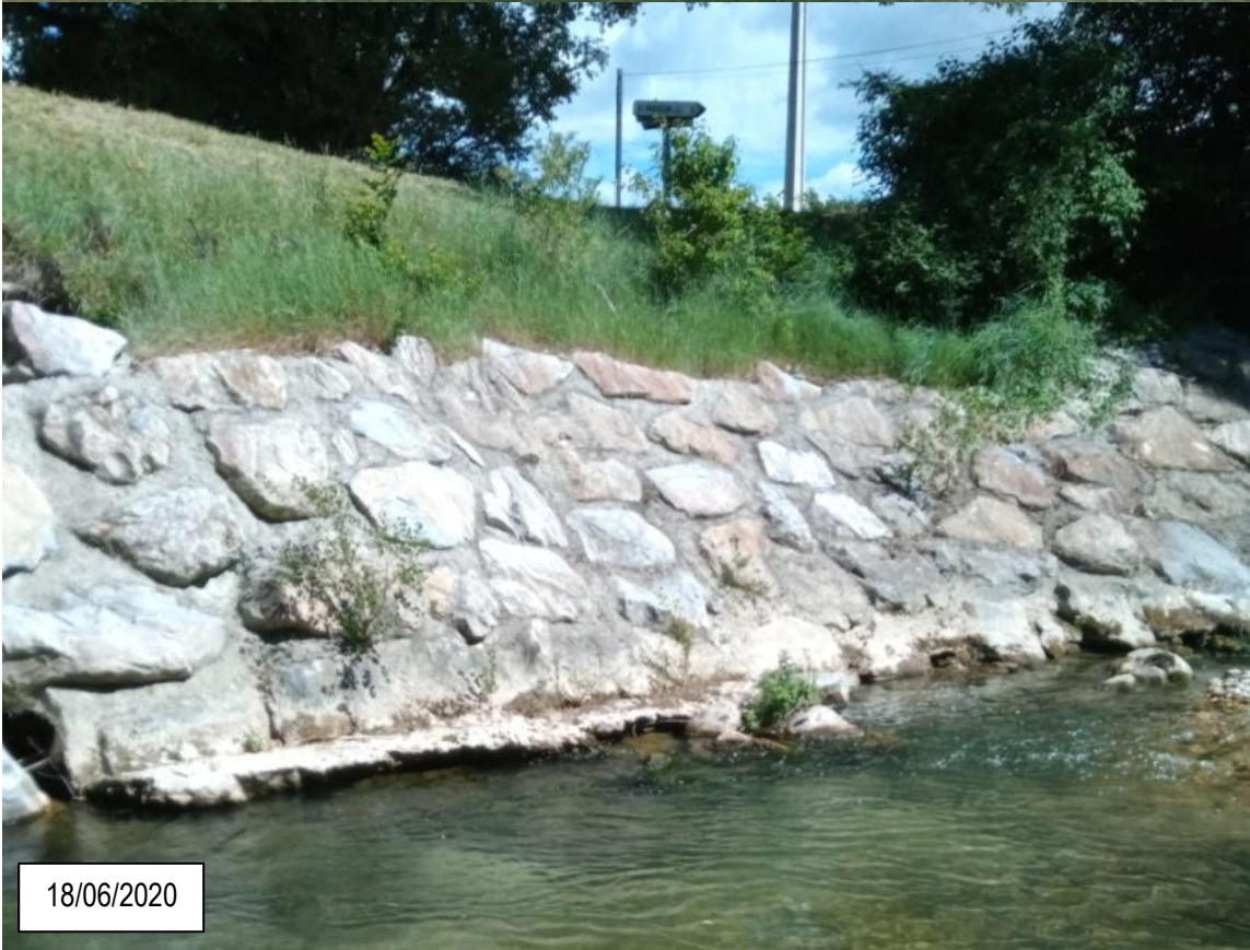
Figure 25 : Berge à conforter en rive droite
