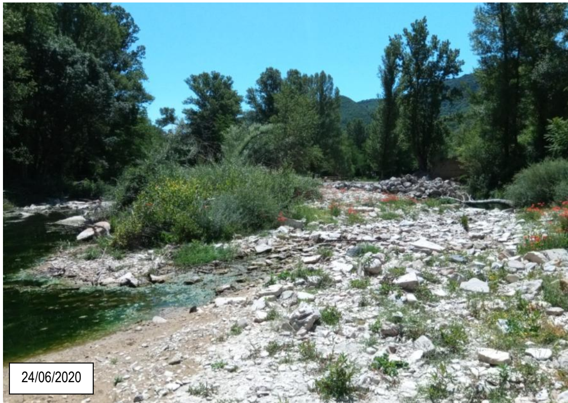
Figure 3 : Atterrissement à supprimer au premier plan et enrochements en rive droite à reprendre à l'arrière plan (vue depuis l'amont)
