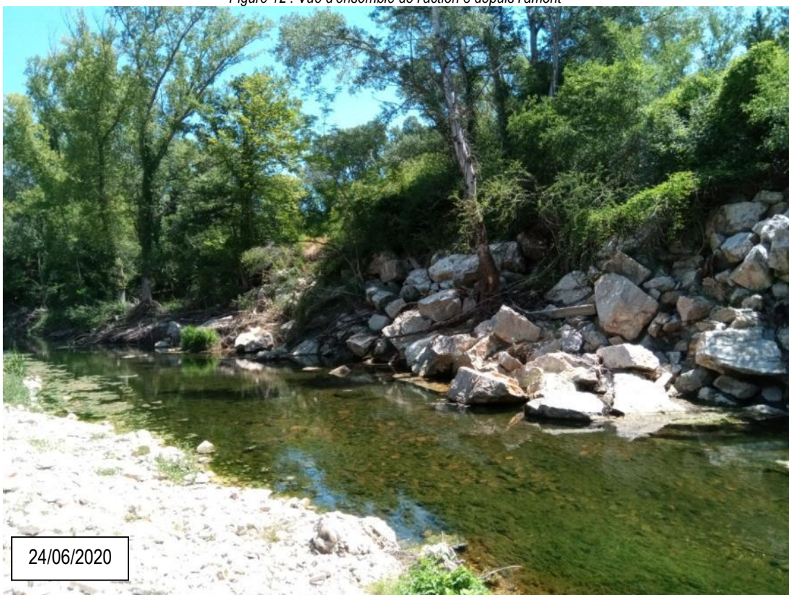
Figure 13 : Enrochements à reprendre en rive droite
