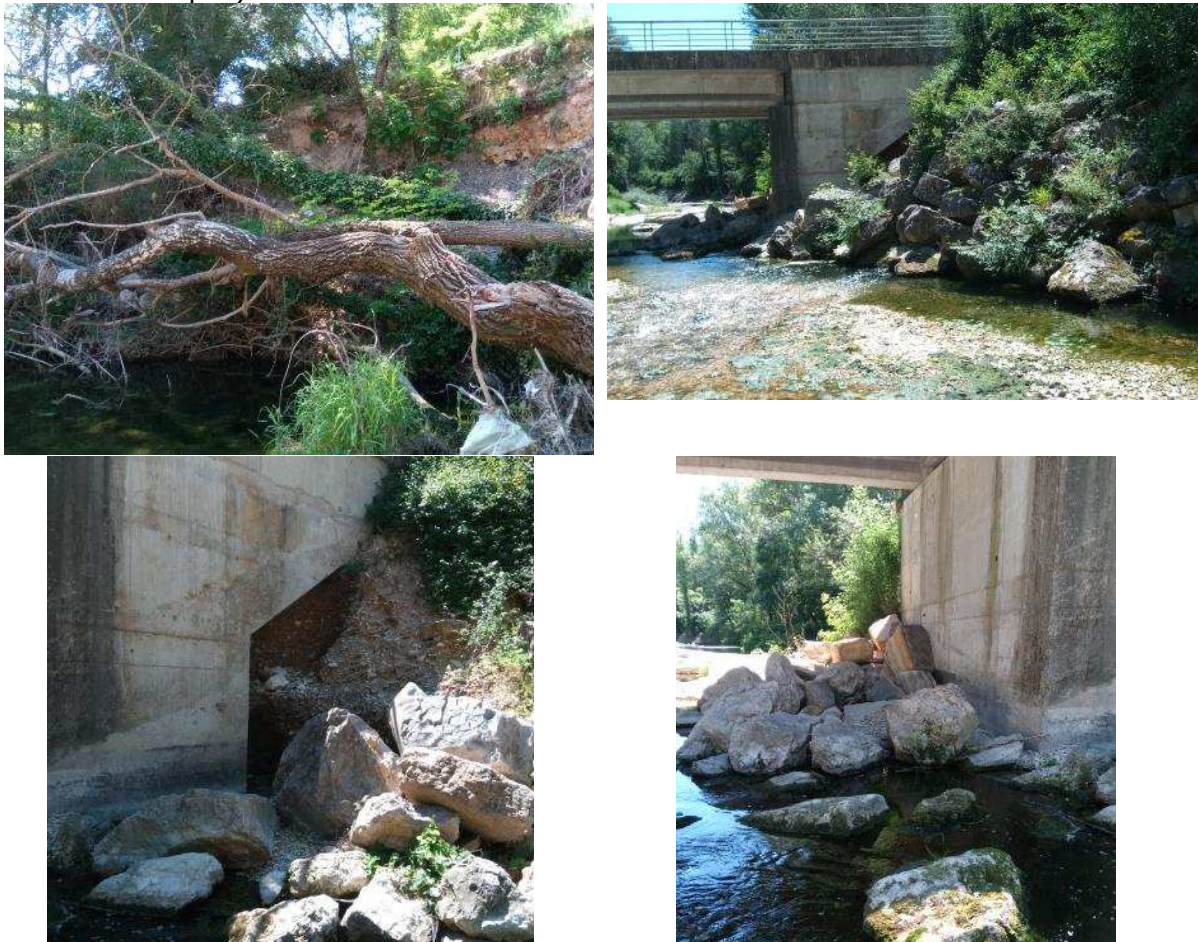
Figure 8 : Anse d'érosion en amont de la protection de berge rive droite (en haut à gauche), protection de berge en mauvais état (en haut à droite), érosion à l'amont de la culée du pont (en bas à gauche), blocs désorganisés en pied de culée (en bas à droite).
