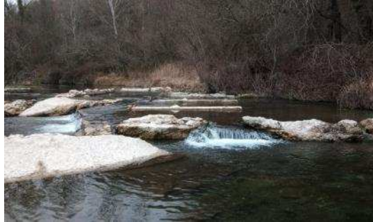
Figure 92 : Radier béton à supprimer.
