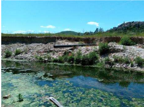
Figure 17 : Vue de l'anse d'érosion en rive droite et de la canalisation.
