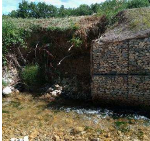
Figure 21 : Anse d'érosion qui s'est développée à l'aval des gabions.
