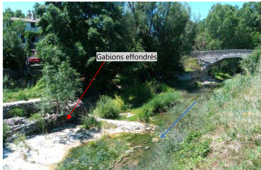
Figure 13 : Protections de berge effondrées en rive droite.
