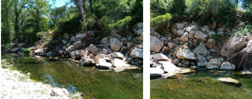
Figure 9 : Protection de berge en mauvais état en rive droite.
