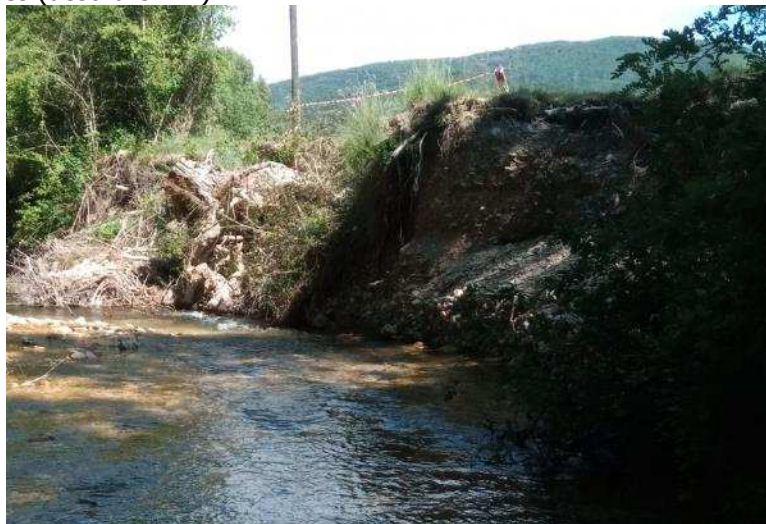
Figure 20 : Anse d'érosion à proximité de la voie communale.
