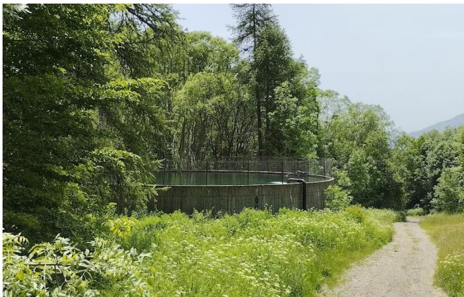
Figure 11 : Réservoir tampon de 1000 m 3 situé quelque centaines de mètre à l'aval de la prise d'eau aval de l'ASA des Marrons
