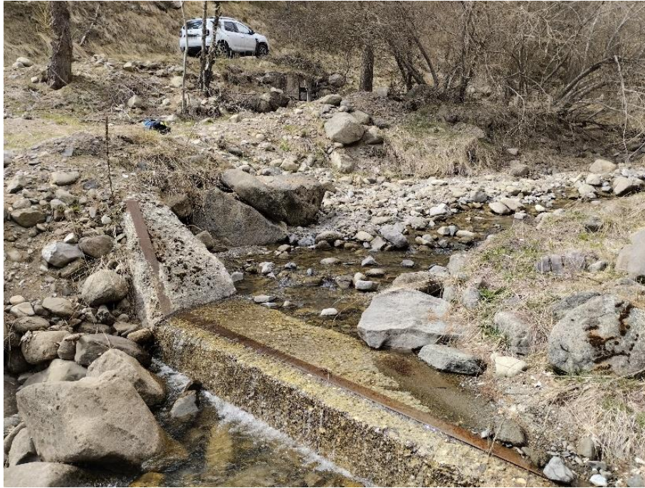
Figure 10 : prise d'eau (dite prise d'eau aval) de l'ASA des Marrons avec un drain enterré dans le lit du Buissard à l'amont du seuil béton.
