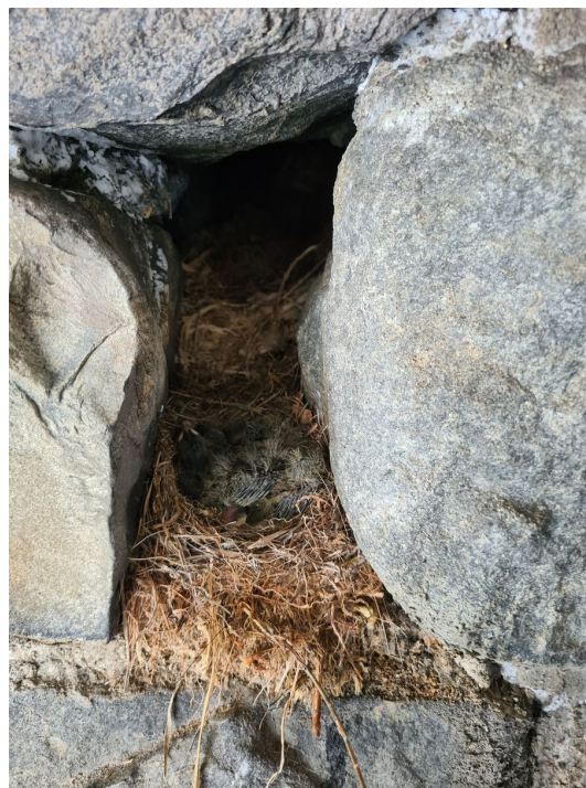
Barbacane de l'ouvrage occupée par un nid – CD04-mai 2023
