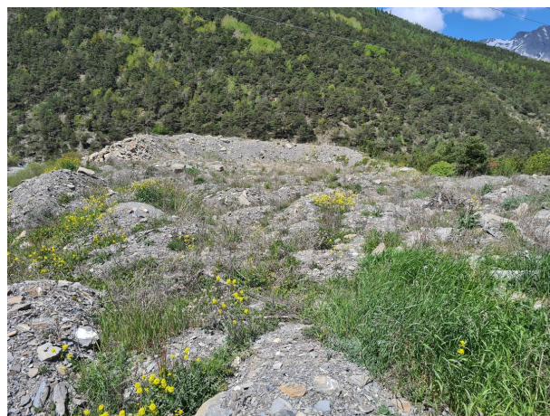
Berge droite aval - Tas de gravats – CD04-2023
