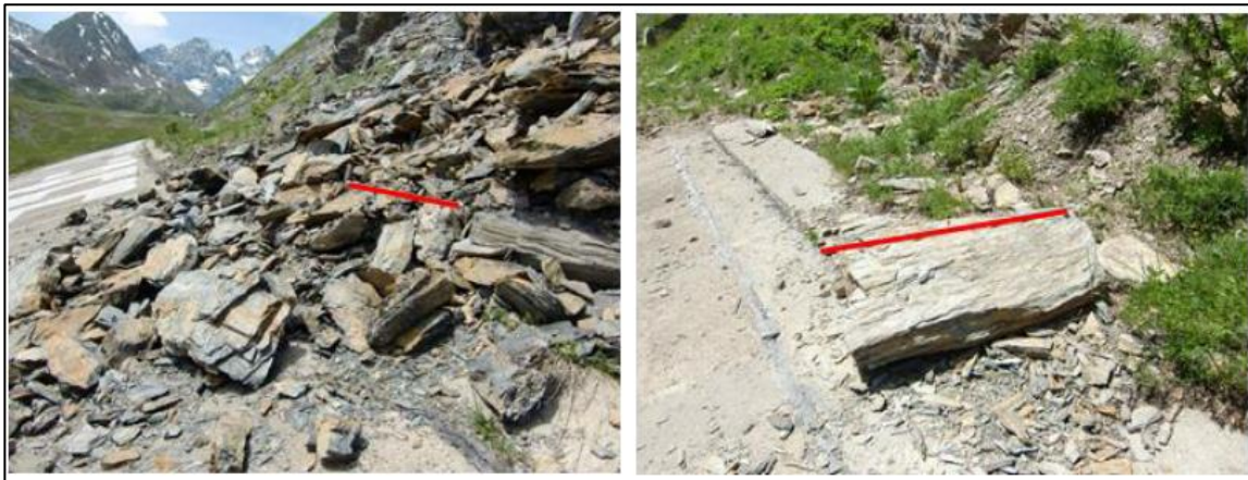
Figure 23 : Dépôts de chutes de pierres et de blocs sur la galerie (ligne rouge = 1 m) (source : GEOFORMER IGP, 2022)
