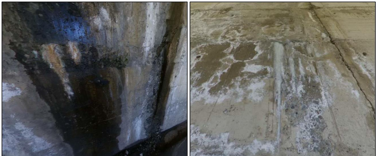
Figure 15 : Illustration de la dégradation de la galerie
