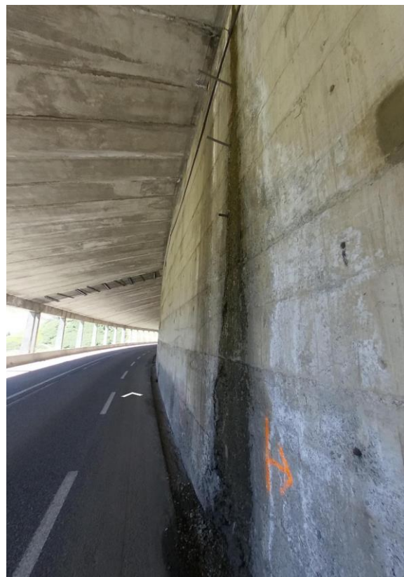
Figure 21 : Exemple de fissure aquifère
