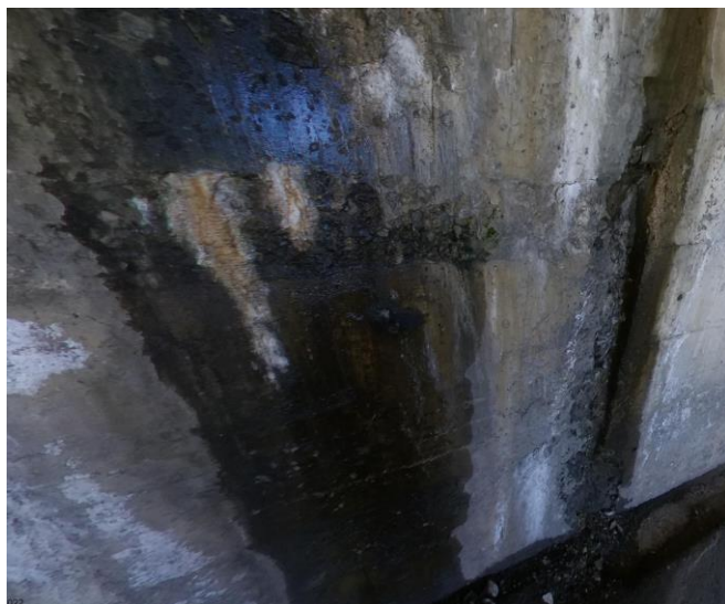
Figure 20 : Exemple de fissure aquifère
