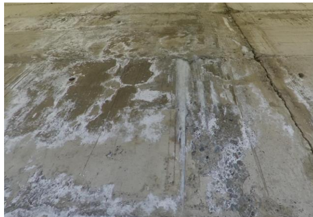
Figure 16 : Altération localisée du parement à mi-hauteur
