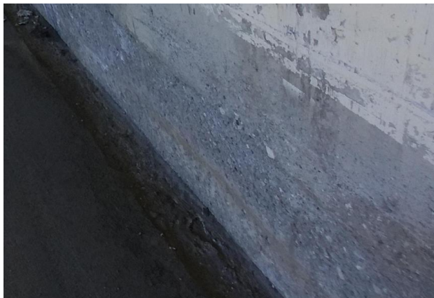
Figure 15 : Altération du parement en pied du mur
