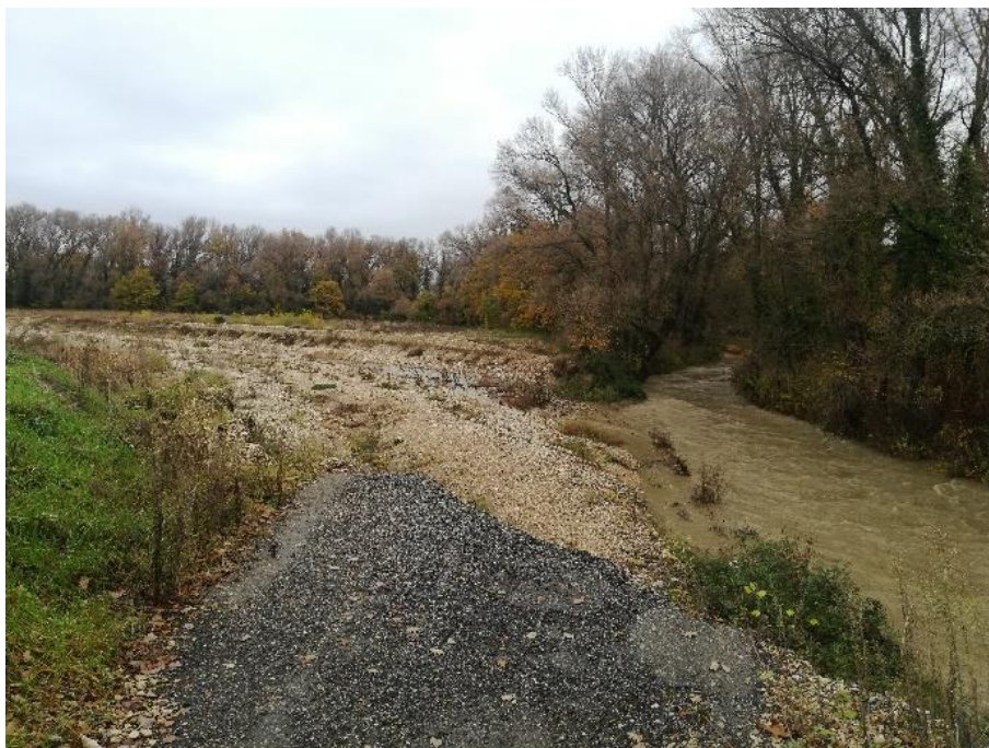
Figure 17 : Chemin rural emporté par la crue de 2019
