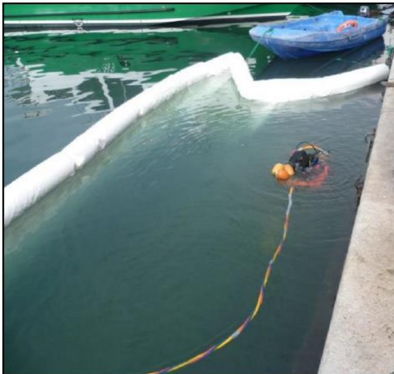
Figure 6. Utilisation d'un filet anti-MES similaire lors des travaux de réhabilitation des quais du port de St-Tropez ICTP 2011
