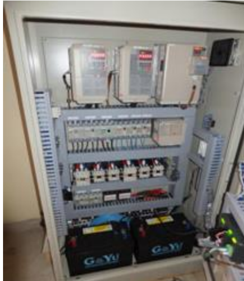
Photo illustration panneau de contrôle (local technique)
