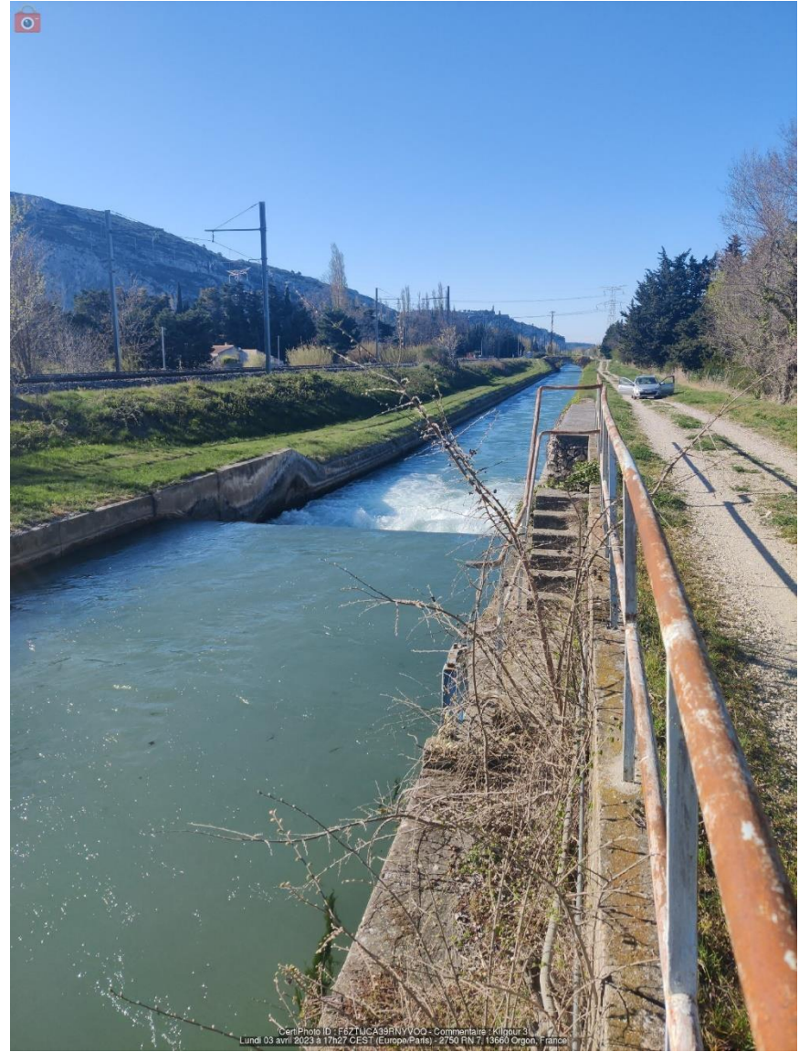
Photo 4 : Chute vers l'aval rive droite
