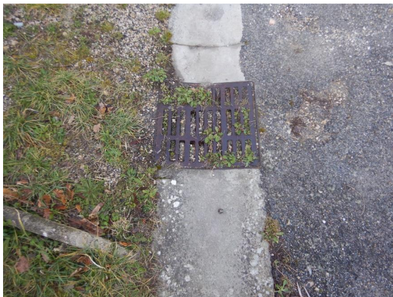
Figure 7 – Grille avaloir au droit du projet (bouchée)
