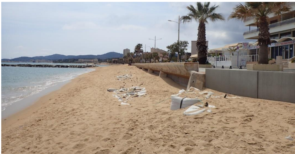
Figure 8 : Big-bags mis en place en mesure d'urgence (ICTP – avril 2021)
