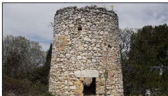
Ruine où se trouve le nid de Faucon crécerelle et potentiellement favorable à la Huppe fasciée
