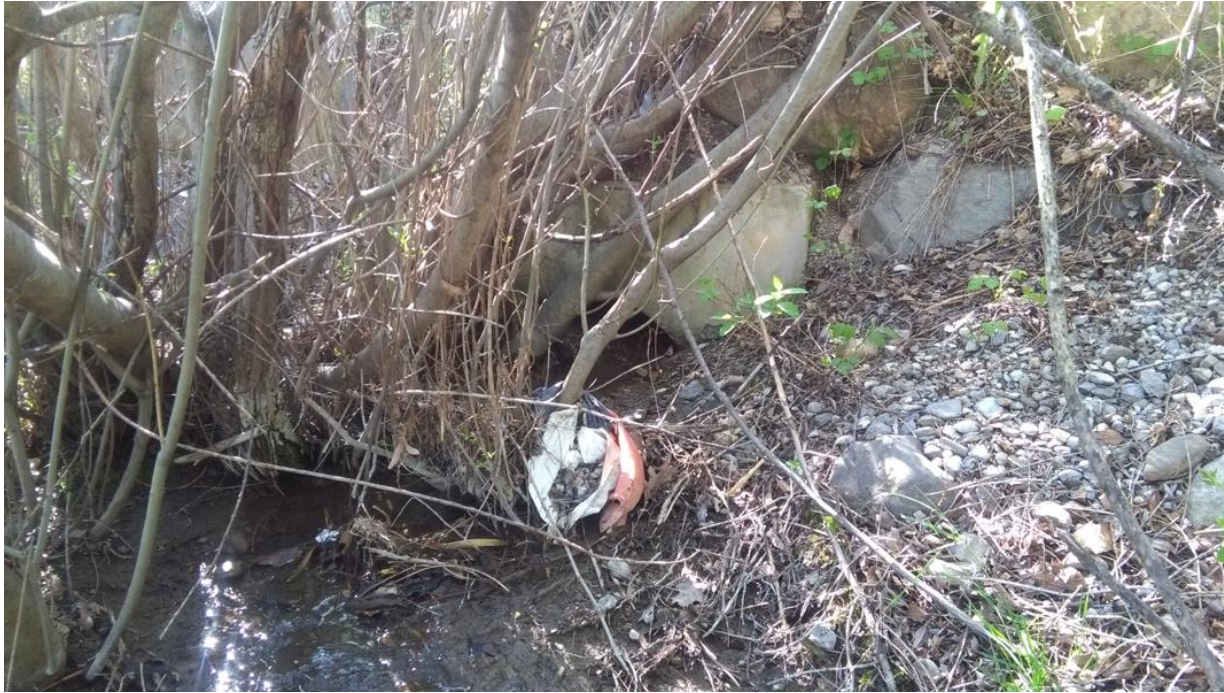
Figure 11 : apport visible dans le talus routier aval depuis un nouvel ouvrage
