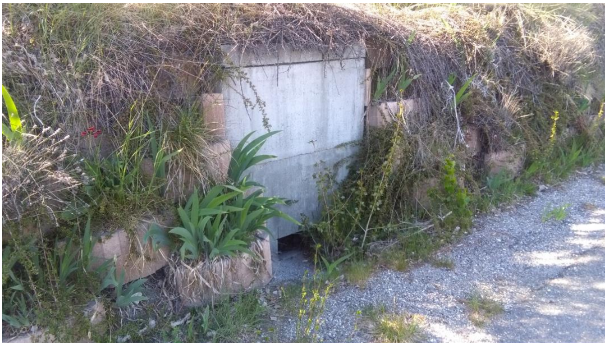
Figure 12 : ouvrage de collecte sur la route de Chalvet à l'aplomb de la sortie d'eau
