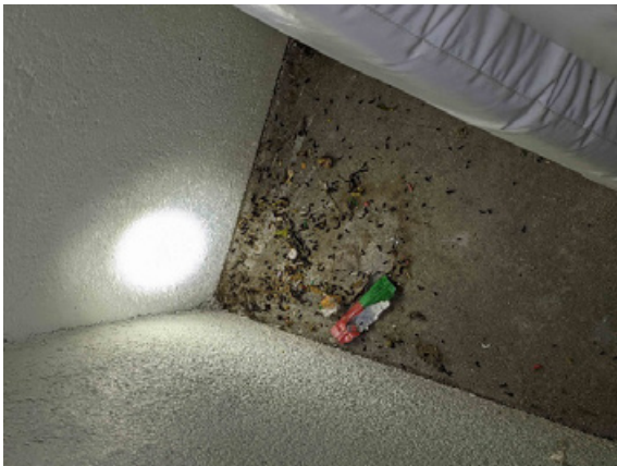
Guano dans bâtiment n°10
