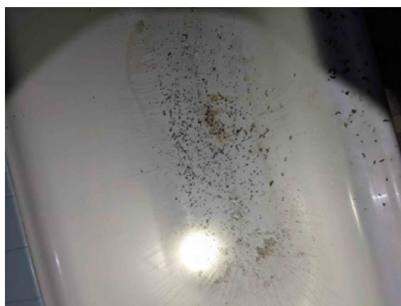
Guano dans bâtiment n°16
