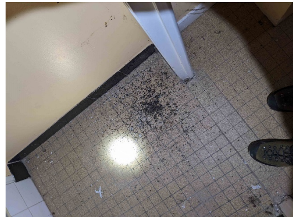
Guano dans bâtiment n°17
