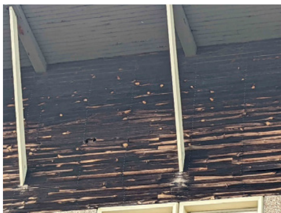
Trou dans le bardage du bâtiment n°13
