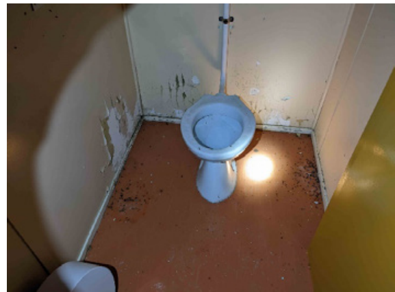
Guano dans bâtiment n°21
