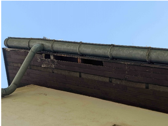
Trou dans la toiture du bâtiment n°7
