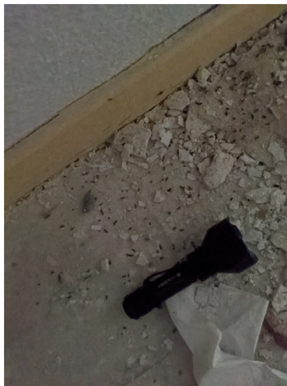
Guano dans bâtiment n°17
