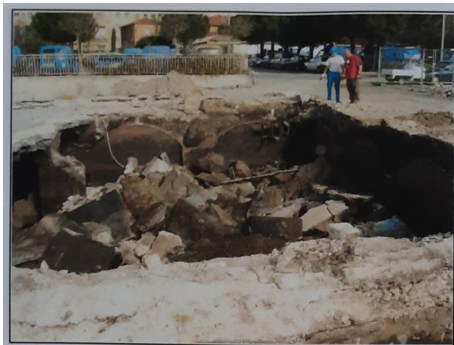
Figure 16 : Démolition du toit et des piliers de la cuve C1-A après vidange et nettoyage (Source : rapport EAT)
