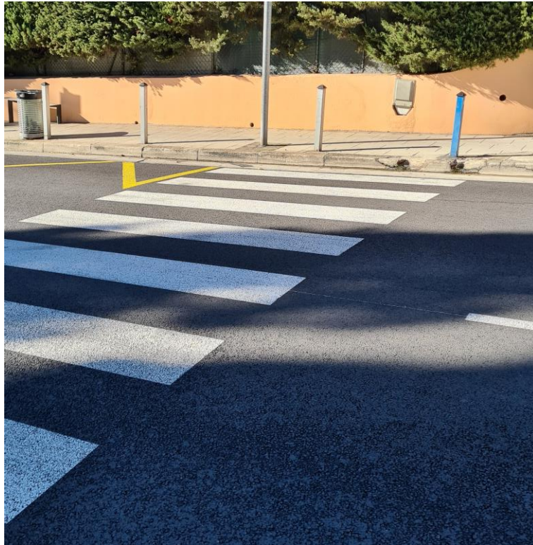
Figure 14. : Vue sur une traversée piétonne non conforme Av de Brancolar
