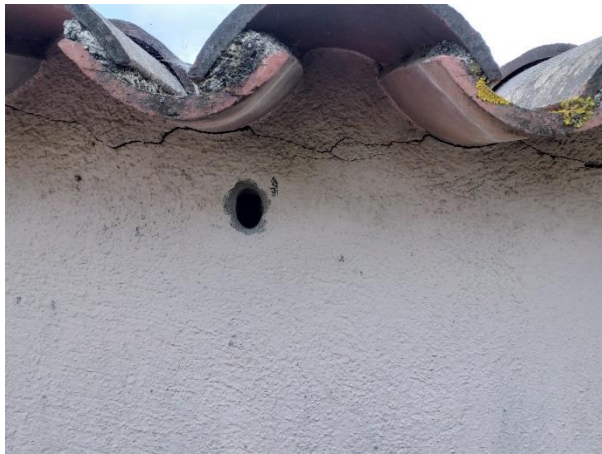
Bâti favorable présentant des trous dans une façade sous tuiles (parcelle 153)
