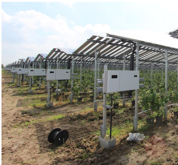
Figure 12 : Exemple d'onduleurs "strings" installés en bout de rangées du site Agri-PV sur groseilles de Wadenrijen, Pays-Bas (source : BayWa r.e.)
