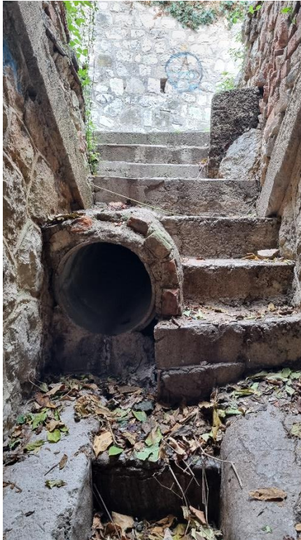
Photo 1 : Amont du tunnel : Réseau EP diamètre 400mm se déversant dans le tunnel
