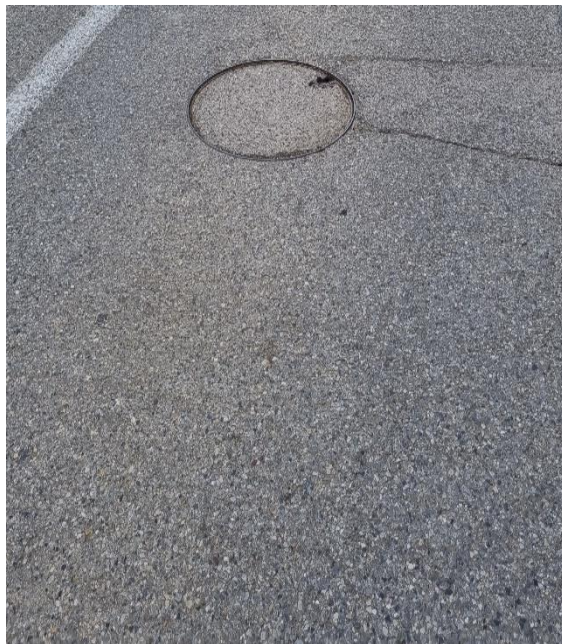
Photo 4 : Réseau EU communautaire sur la voie. / Réseau EP sous le trottoir sud.
