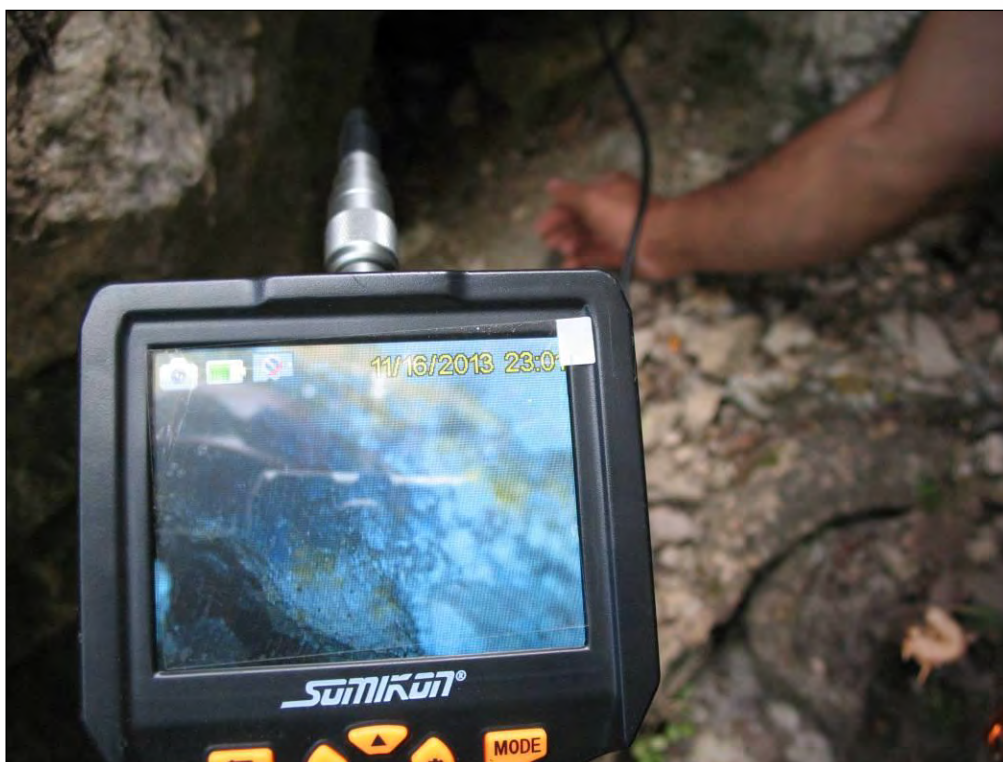
Utilisation de l'endoscope : vue de l'écran de contrôle, l'embout étant dans une fissure
