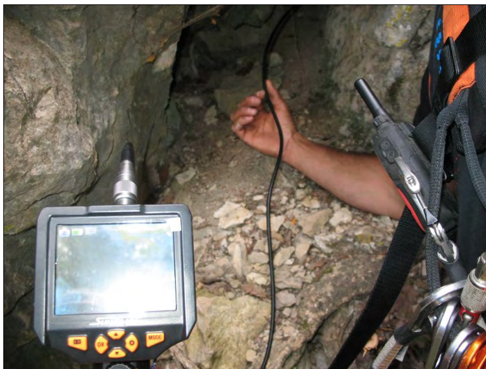
Utilisation de l'endoscope : écran de contrôle et embout entrant dans une fissure
