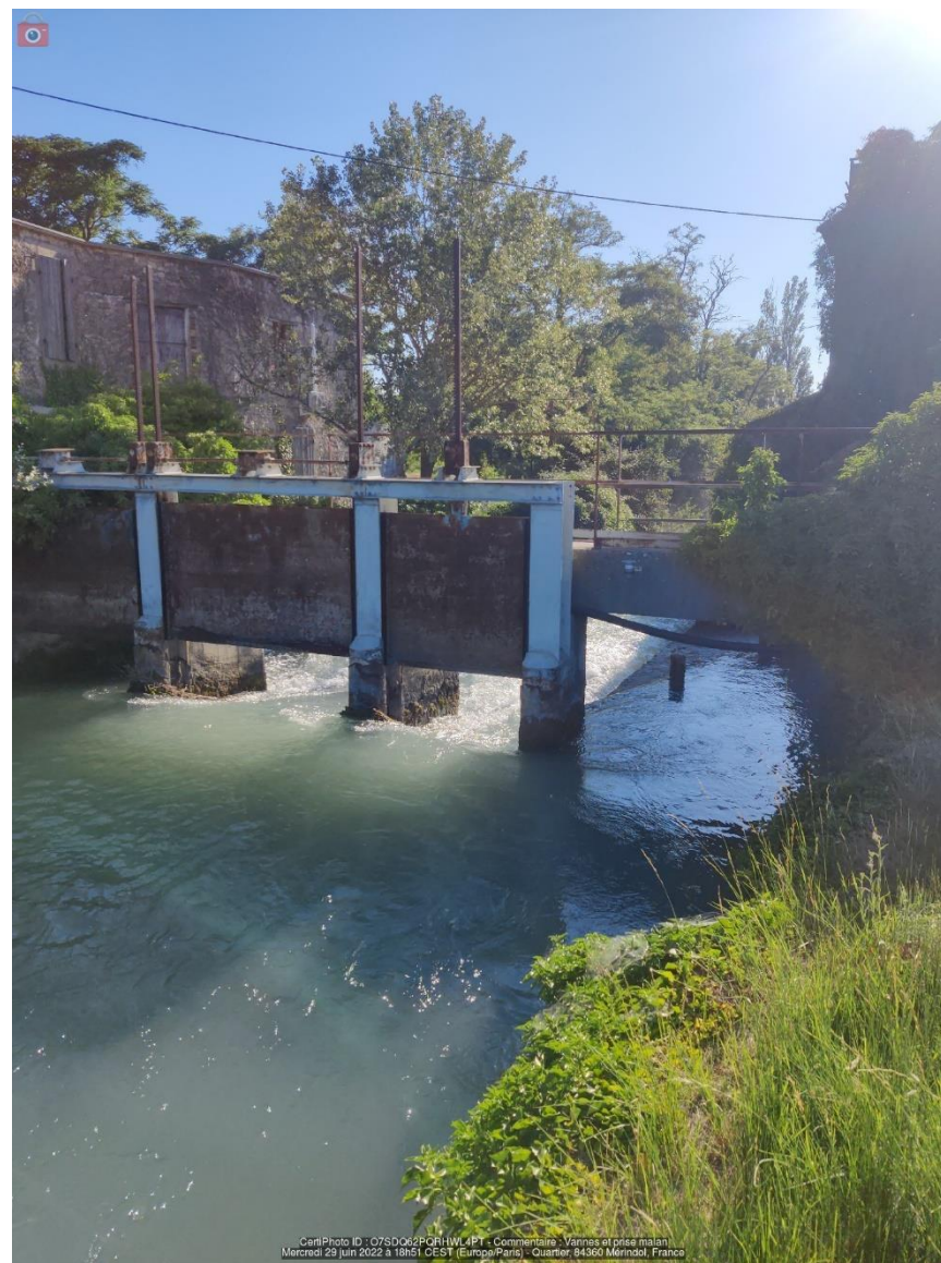
Photo 2 : Vannes et prise d'eau
