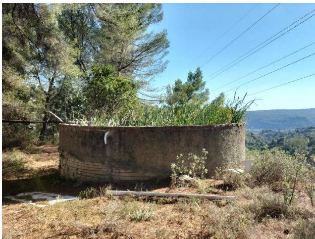
Figure 24 : Photographie du réservoir d'eau favorable aux amphibiens
