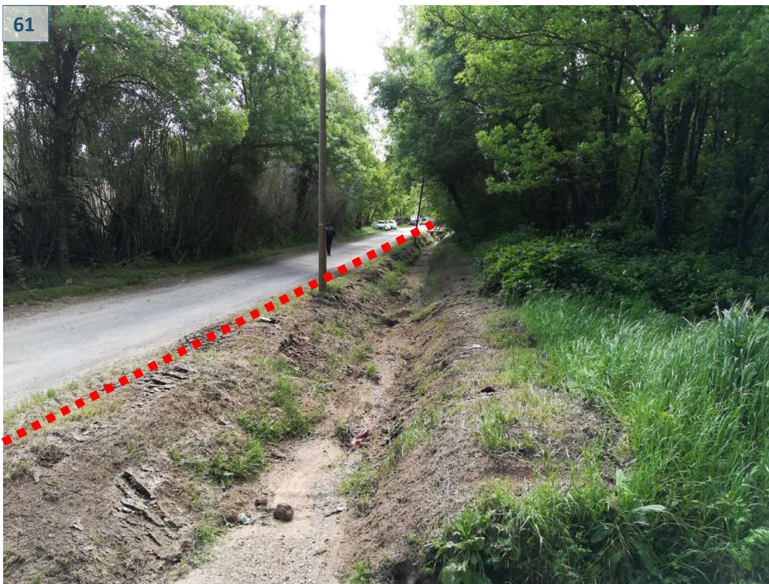
Photo 61 : Passage sous chemin de Giegi
