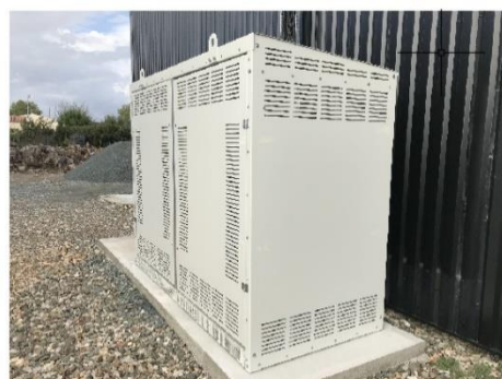
Exemple d'une armoire technique
