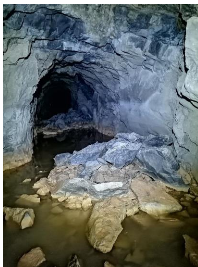
Rocher altéré avec éboulement latéraux (PM1040)
