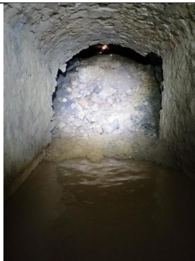
Eboulement amont (PM30)
