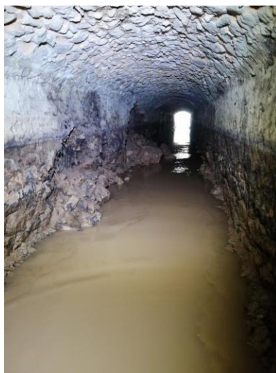
Eboulement de maçonneries en rive gauche (PM4040)
