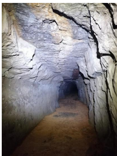
Voûte rocher fissuré (PM1280)
